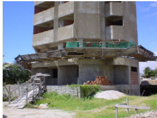
c) Pavimento térreo – obra paralisada
