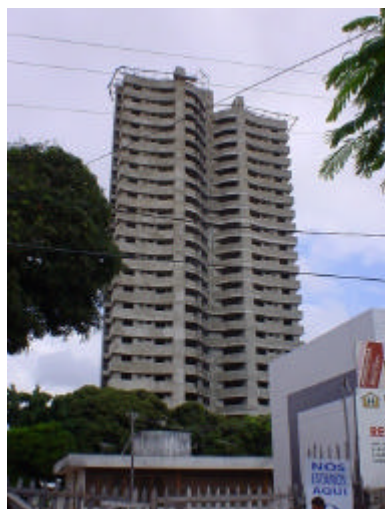
c) Torre de apartamentos - obra paralisada
