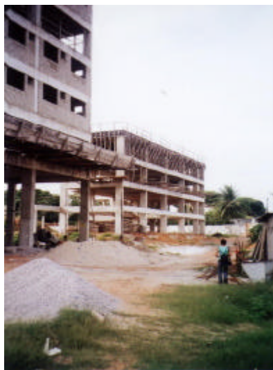
b) Obra paralisada
