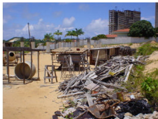
b) Canteiro de obras – obra paralisada
