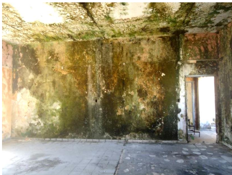
Figura 4.38: Ilustrando mofo e bolor no revestimento argamassado.
