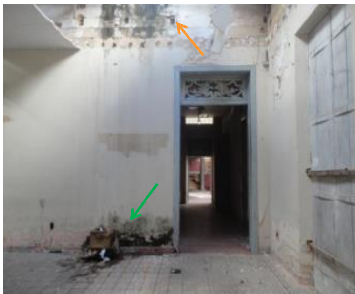
Figura 4.19: Manchas umidade e mofo e bolor na base da parede.
