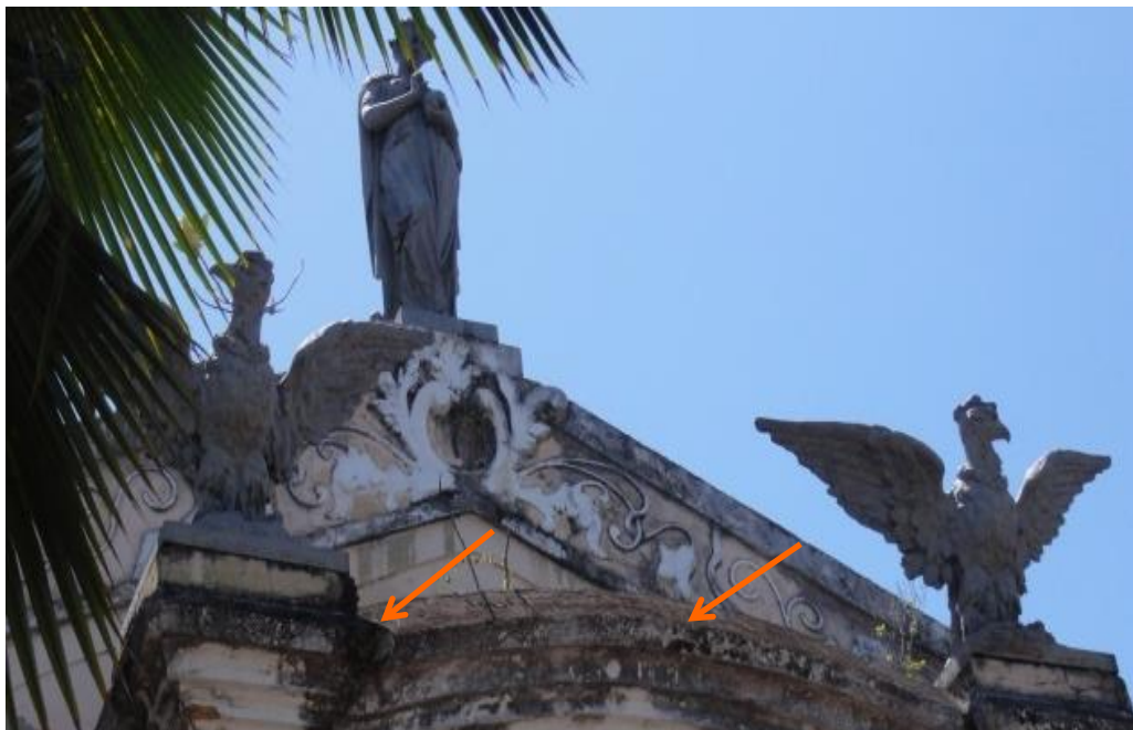
Figura 4.7: Detalhe da fachada frontal, mostrando sujeira na cimalha e nos detalhes arquitetônicos.
