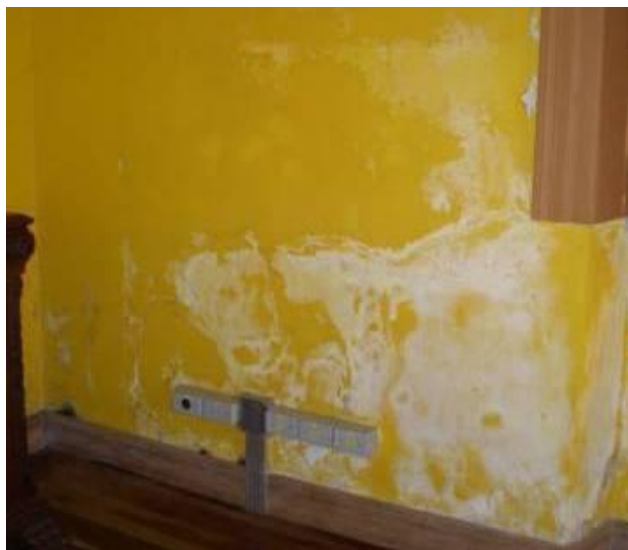
Figura 2.9: Presença de eflorescência através de manchas esbranquiçadas.
