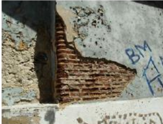
Figura 2.11: Exemplo de expulsão de argamassa em estágio avançado até a exposição da alvenaria, mostrando tijolos cerâmicos e argamassa de assentamento.
