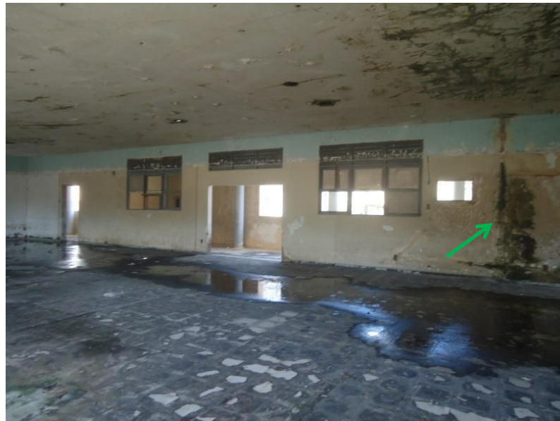
Figura 4.34: Manchas de umidade com presença de mofo e bolor.
