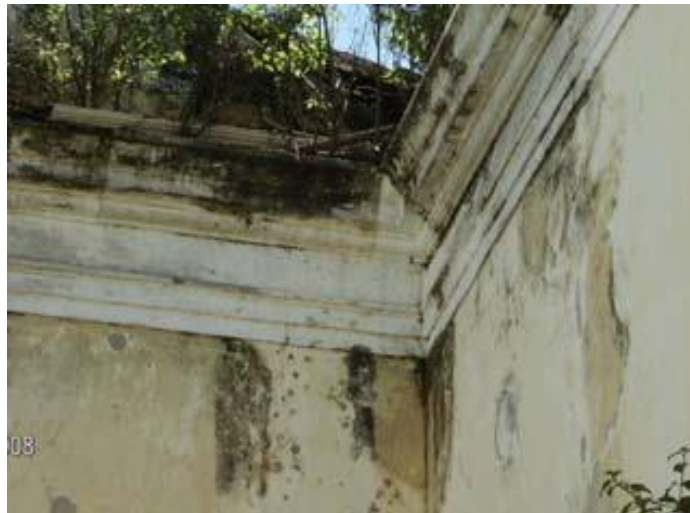
Figura 2.12: Presença de fungos no topo da parede.
