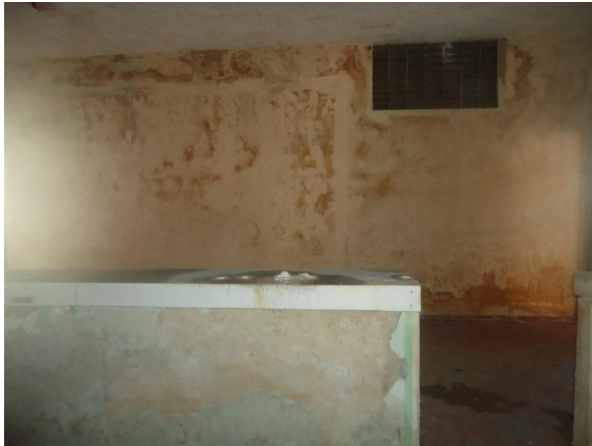
Figura 4.30: Ilustrando manchas de umidade na parede.
