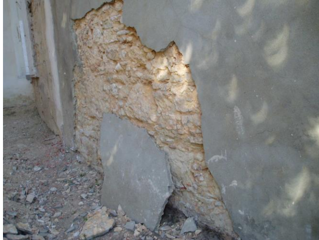
Figura 2.14: Revestimento inadequado de cimento: destacamento e degradação da base.
