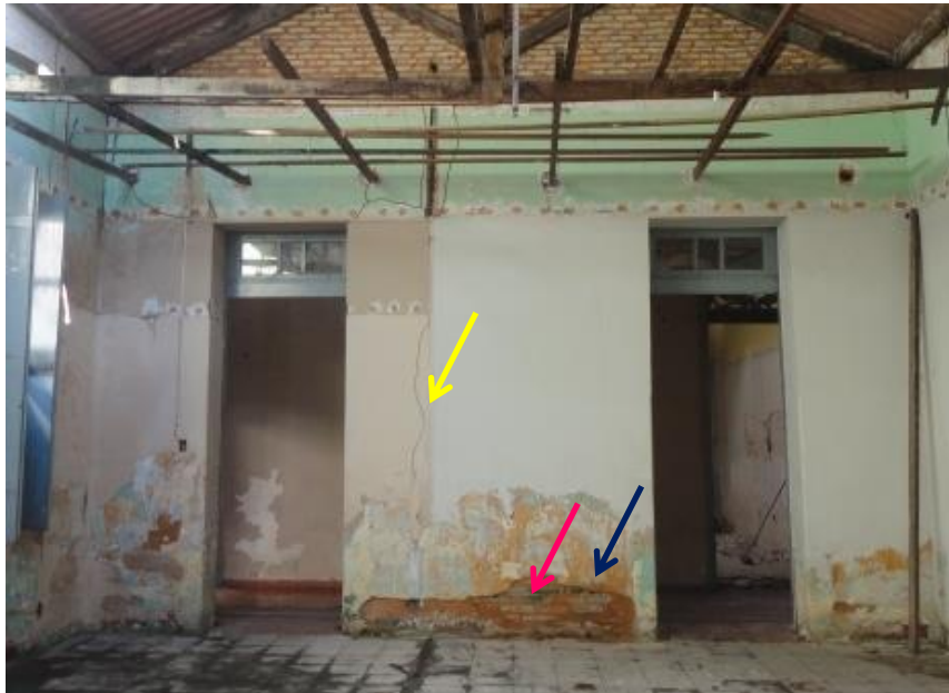
Figura 4.22: Ilustrando manchas de umidade, desprendimento com exposição da alvenaria e fissuração.
