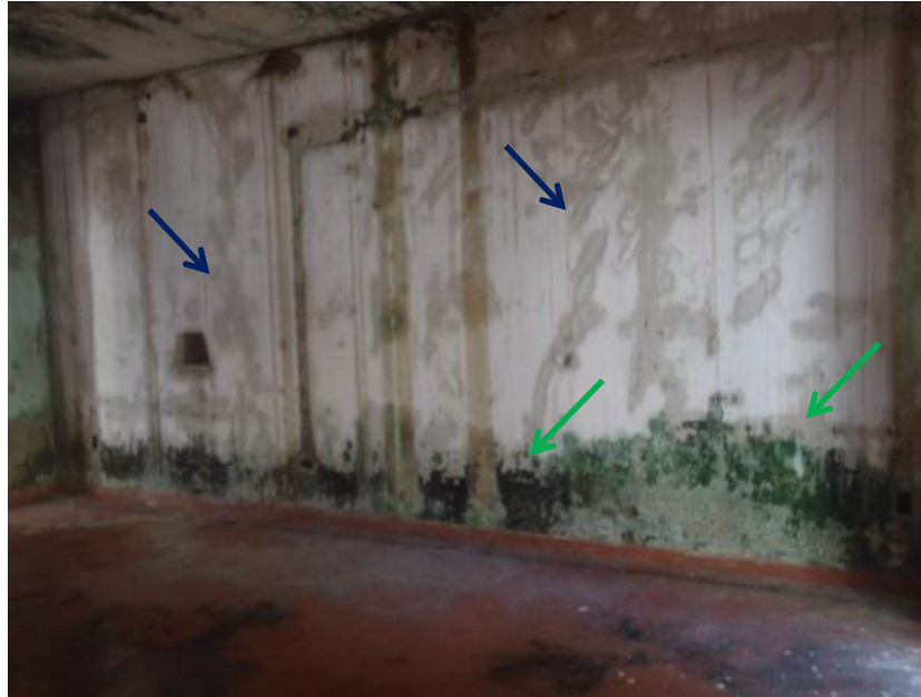
Figura 4.26: Ilustrando manchas de umidade em toda a parede e presença de mofo e bolor na parte inferior e superior da parede.
