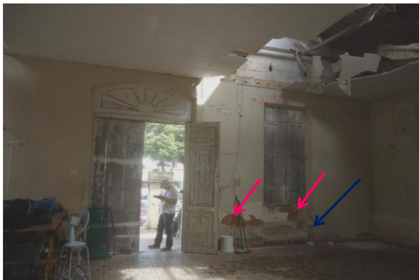
Figura 4.17: Ilustrando o desprendimento do revestimento e manchas de umidade.
