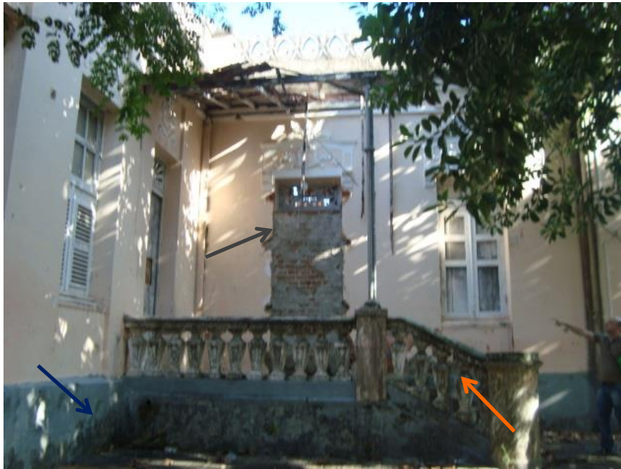
Figura 4.11: Detalhe da fachada lateral esquerda, mostrando sujidade no guarda-corpo, manchas de umidade e utilização de material inadequado.
