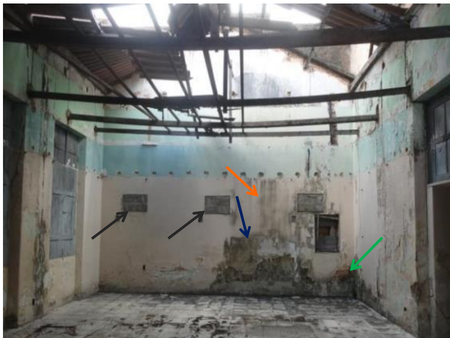
Figura 4.23: Ilustrando manchas de umidade, sujidade, mofo e bolor e uso de material inadequado.
