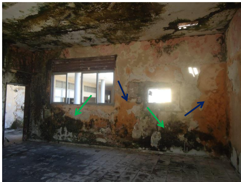
Figura 4.37: Manchas de umidade e presença de mofo e bolor.
