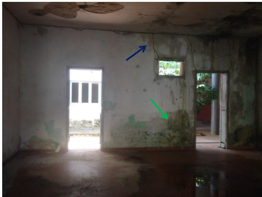
Figura 4.27: Ilustrando manchas de umidade na parte superior e mofo e bolor na parte inferior, no lado direito da imagem.
