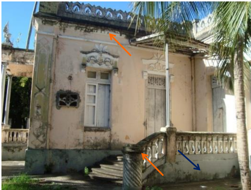
Figura 4.13: Detalhe da fachada lateral direita, mostrando manchas escuras de umidade na base da parede e no guarda-corpo.
