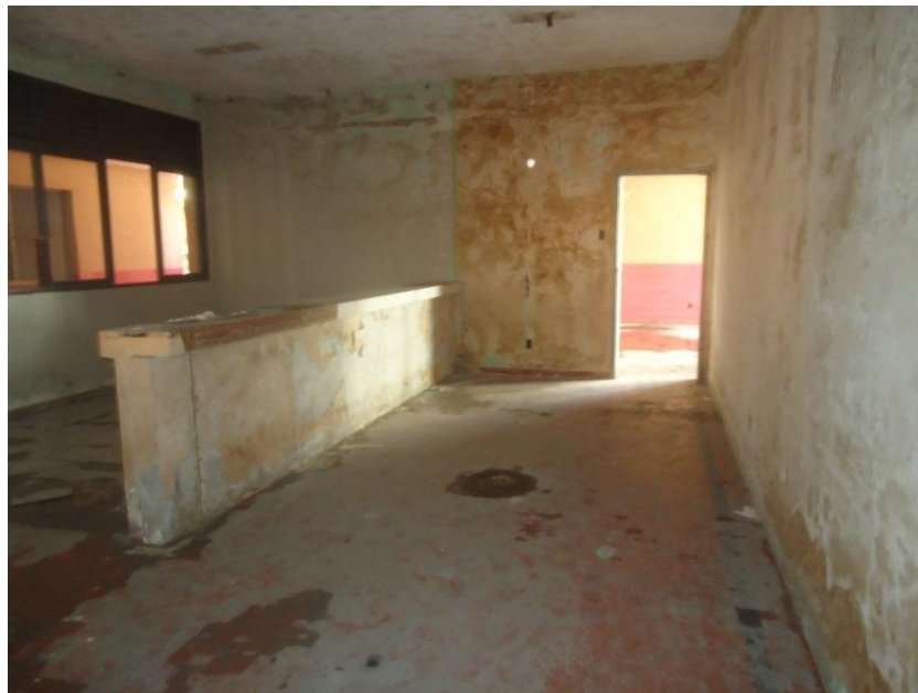
Figura 4.31: Ilustrando manchas de umidade no revestimento argamassado.
