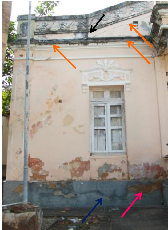
Figura 4.6: Detalhe de parte da fachada frontal, mostrando manchas de umidade, desprendimento do revestimento e sujeira.
