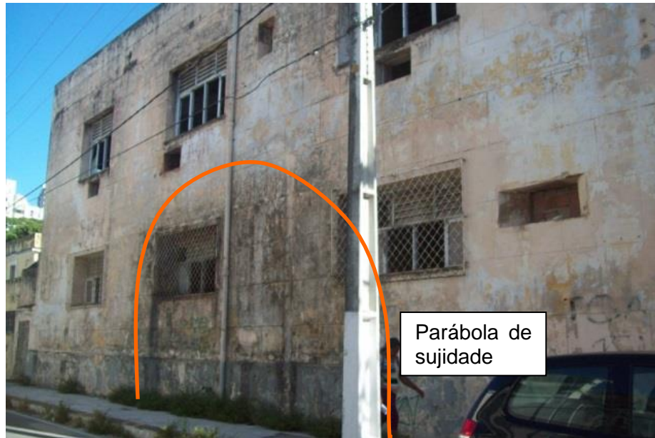
Figura 4.10: Detalhe da fachada lateral esquerda, mostrando sujidade na parte superior e a parábola de sujidade no meio da fachada.
