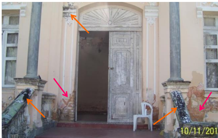
Figura 4.8: Detalhe da fachada frontal, mostrando sujeidade e desprendimento do revestimento na parede.
