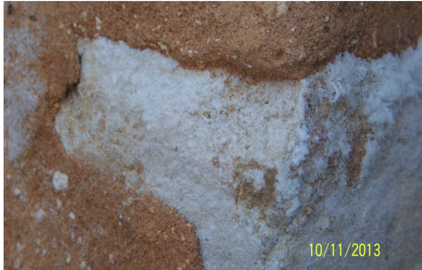
Figura 4.18: Eflorescência observada na imagem da Figura 4.17, com maior ampliação.
