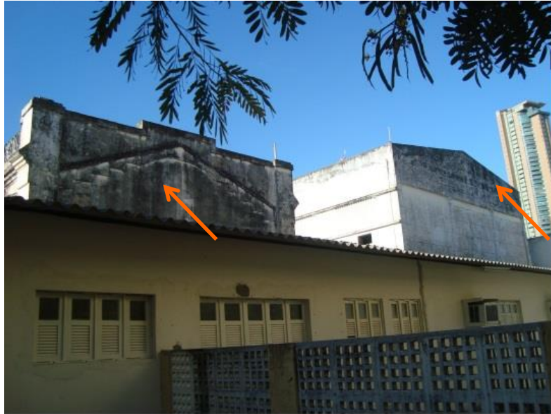
Figura 4.14: Detalhe da fachada lateral direita, mostrando sujidade.
