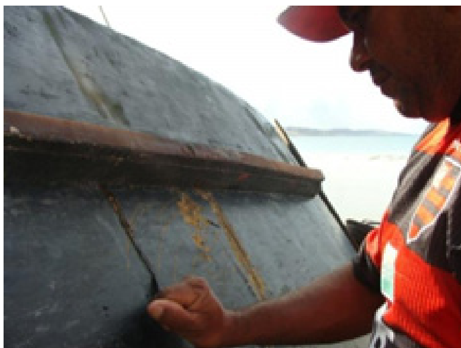
Figura 56: Compensado danificado devido a impacto com rolo de coqueiro. Fonte: Acervo do Projeto Jangadeiros (GREPE/UFRN)
