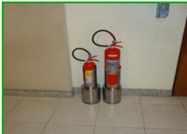
Figura 85 - Extintores de incêndio com suportes para chão.
