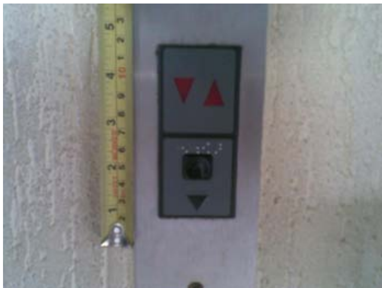
Figura 34 - Botoeira de chamada do elevador instalada de “cabeça para baixo”.
