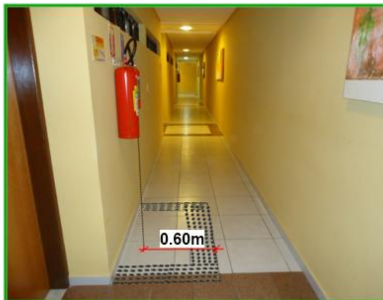
Figura 84 - Proposta de sinalização tátil de alerta próximo aos extintores de incêndio.
