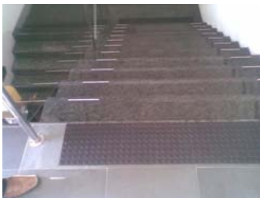
Figura 27 - Piso tátil instalado incorretamente.
