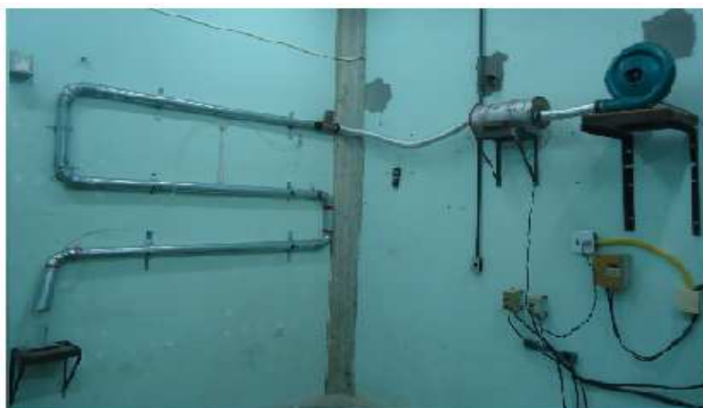
Figura 11 – Sistema de secagem pneumática tipo flash .
