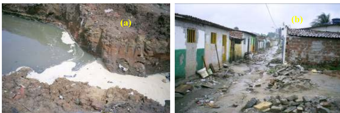
Figura 7.0 – (a) efluentes provenientes do canal do Baldo; (b) situação em que se encontra algumas ruas da comunidade Passo da Pátria durante a obra de urbanização.
