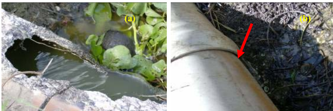
Figura 4.0 – (a) perfuração nas encanações da CAERN; (b) perfuração nas encanações da CAERN.
