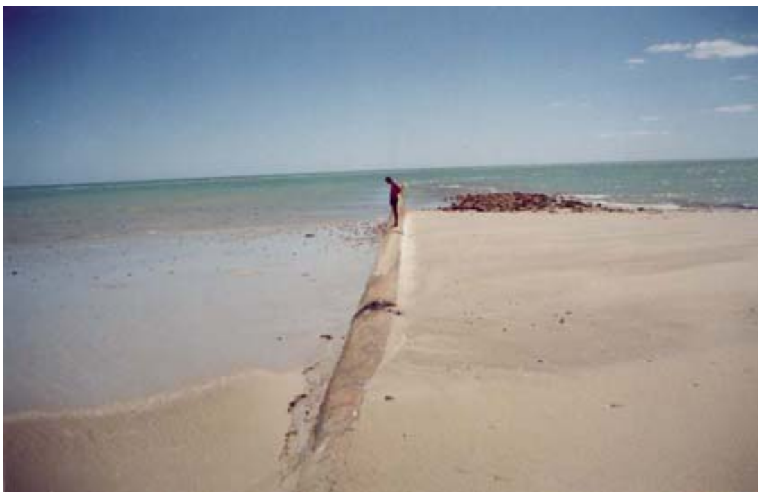
FIGURA 4.36 – Evidencia deposição na porção leste do duto e erosão na porção oeste (perfil 1) (Silveira/julho/2001).
