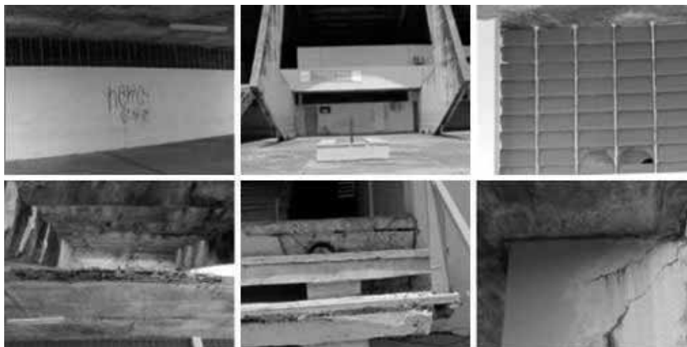
Figura 20 – Danos encontrados nas fachadas do Geraldão. Fonte: Geossistemas Engenharia & Planejamento.
