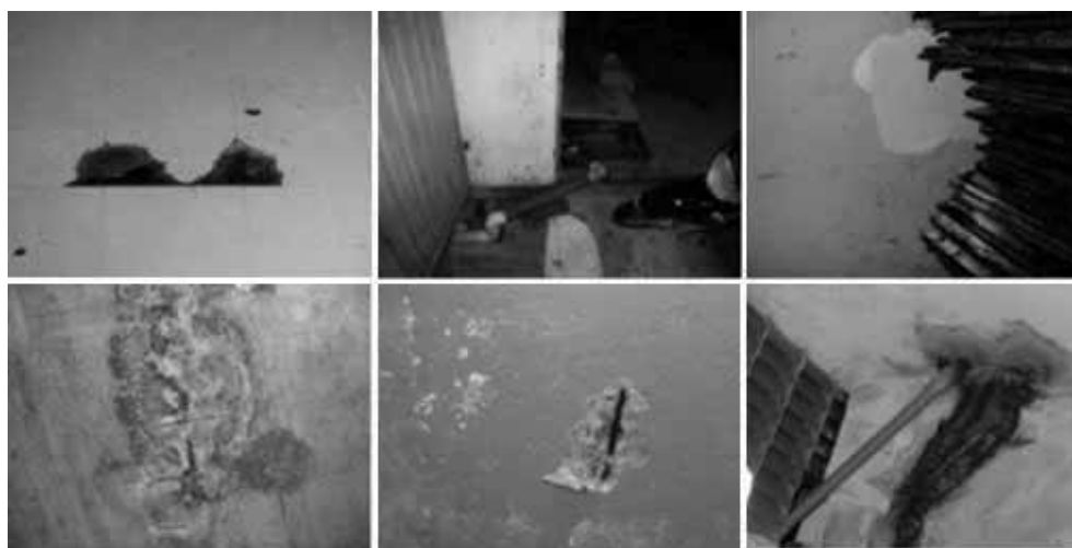
Figura 18 – Danos encontrados nas áreas internas do pavimento térreo do Geraldão. Fonte: Geossistemas Engenharia & Planejamento.
