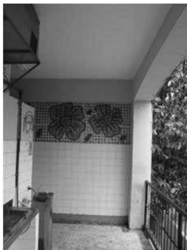
Figura 9 – Situação atual do fechamento de cobogós dos banheiros. Fonte: Acervo dos autores, 2011.
