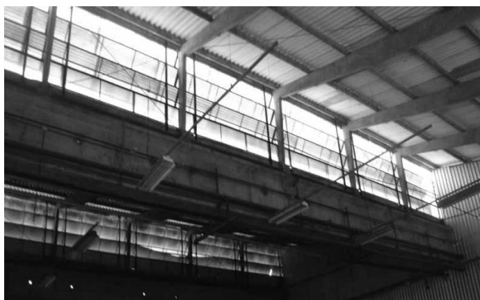
Figura 8 – O sistema de iluminação e ventilação da TCA.
