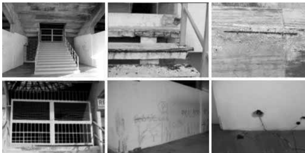
Figura 19 – Danos encontrados nas áreas internas do pavimento superior do Geraldão. Fonte: Geossistemas Engenharia & Planejamento.
