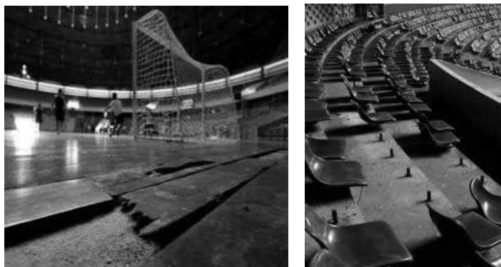
Figura 16 – Detalhe do destacamento da madeira da quadra. Foto: Geossistemas Engenharia & Planejamento.
