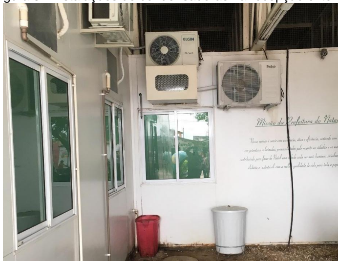
Figura 3 - Instalações de condensadoras na recepção externa.
