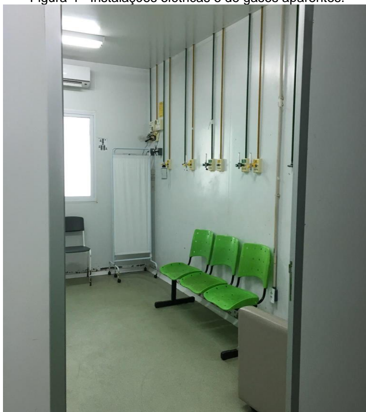
Figura 4 - Instalações elétricas e de gases aparentes.
