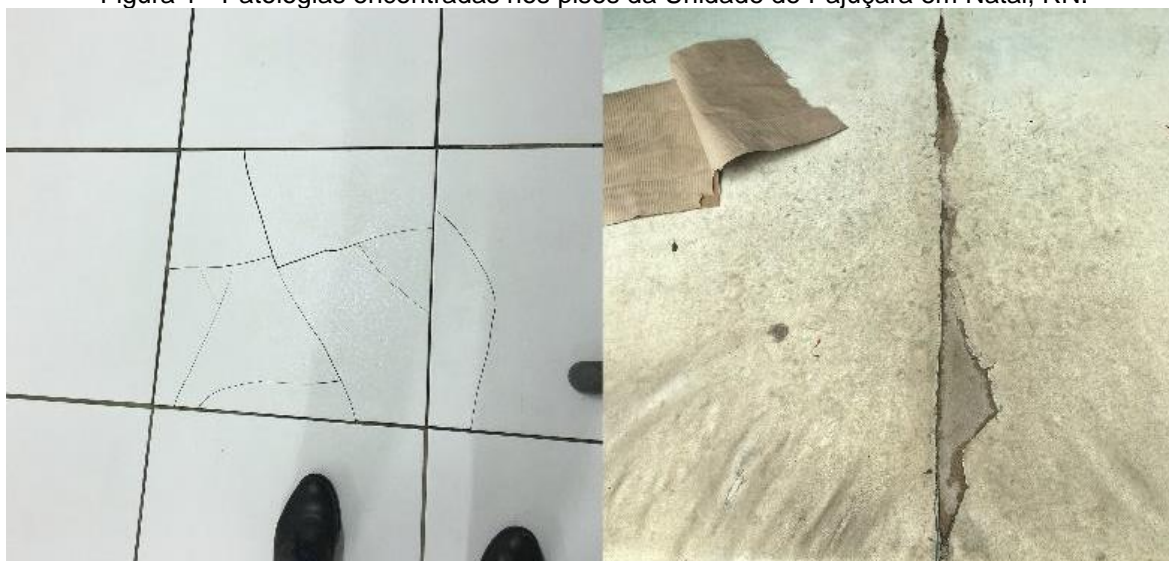
Figura 1 - Patologias encontradas nos pisos da Unidade de Pajuçara em Natal, RN.
