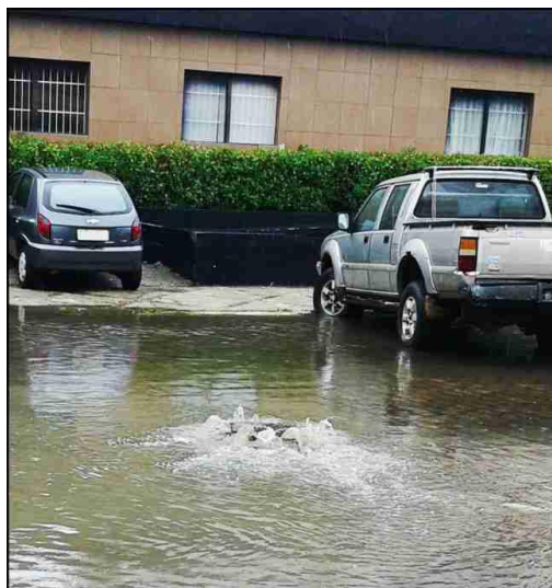
Figura 8 Transbordamento de poço de visita do sistema de esgoto durante alagamento na Rua Açu após evento de precipitação intensa.
