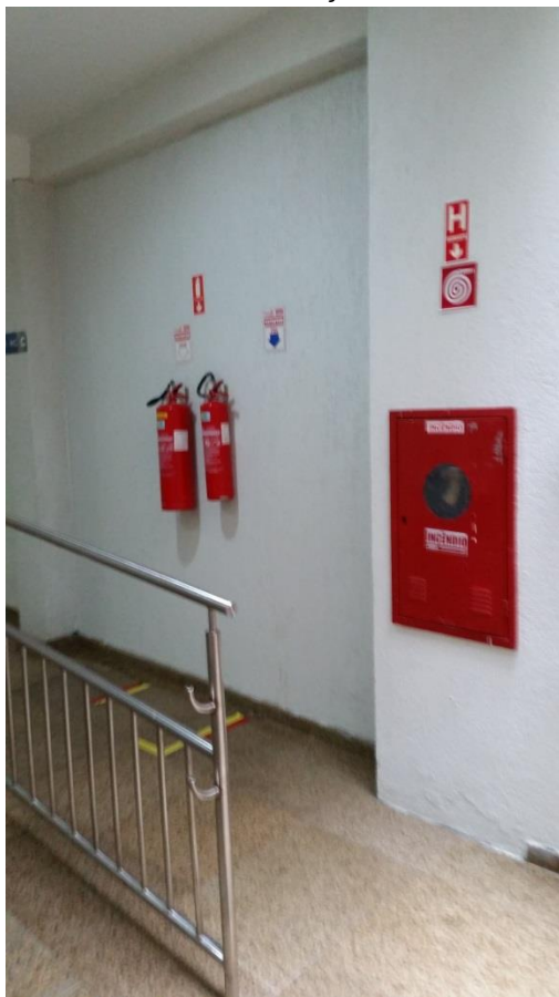
Figura 16: Extintores e hidrante com as devidas sinalizações
