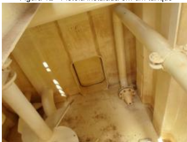
Figura 12 - Pistola instalada em um tanque
