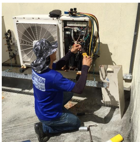
Figura 30 – Serviço sendo realizado em condensadora da ECT
