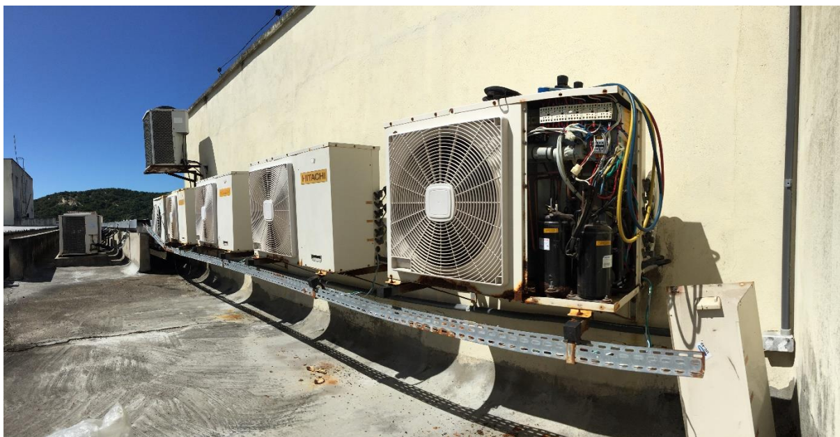
Figura 15 – Um das condensadora da ECT com os elementos expostos.
