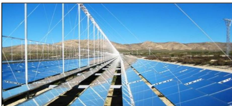
Figura 3.10 – Foto de usina heliotérmica com lentes Fresnel.
