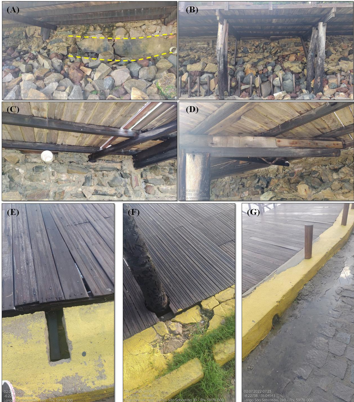
Figura 42 - Estrutura do Deck de Pipa; (A) Viga fissurada; (B) Pilares deteriorados; (C) Ligações das vigas e canos para escoamento pluvial em direção ao enrocamento e praia; (D) Reforços irregulares dos elementos estruturais; (E) Aberturas para apoio estrutural executado de forma inadequada; (F) Patologia na parte superior; (G) Escoamento superficial e evidências de desnível do piso.
