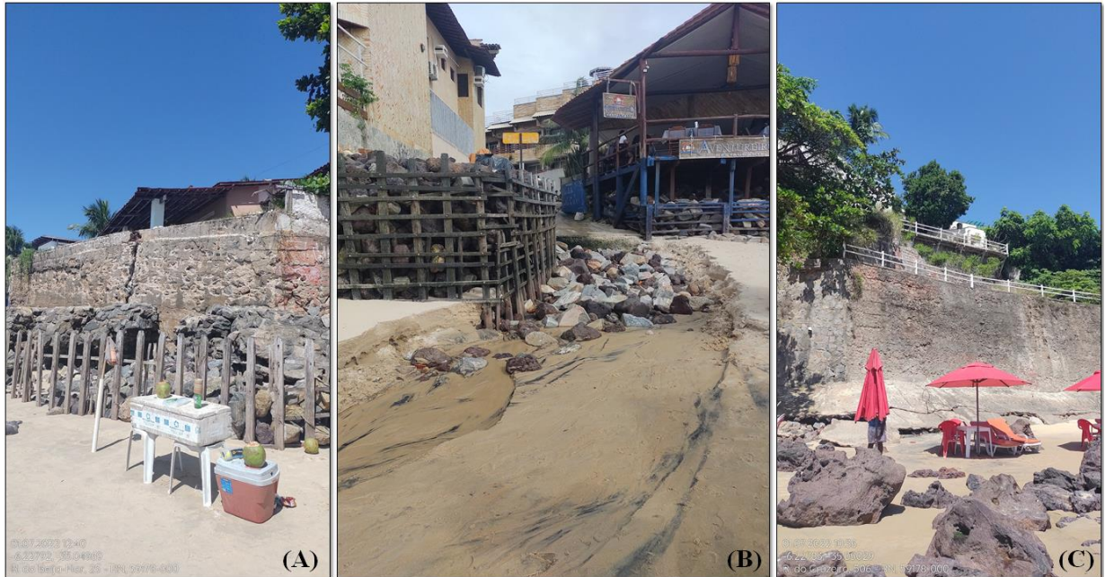
Figura 40 - Estruturas de Contenção Construídas presentes no Setor N; (A) Muro de arrimo fissurado, com enrocamento em gaiola de madeira; (B) Enrocamento em gaiola de madeira, com presença de intensificação do processo erosivo; (C) Estrutura fissurada devido ao esforço gravitacional após o deslocamento dos sedimentos de sua base.
