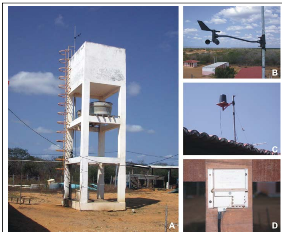
Figura 4.2. Estação meteorológica instalada no topo da caixa d'água da sede administrativa da fazenda de criação de camarões da Camarus Aquacultura do Nordeste Ltda., mostrando o anemômetro (A e B), pluviômetro (C) e o sensor de umidade e temperatura (D).
