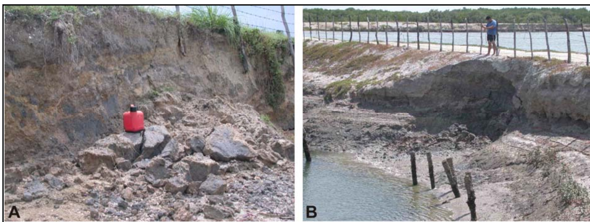
Figura 6.17. Material do talude dos viveiros erodido e transportado para o interior dos CDs em frente ao perfil P3 (A) e entre o P3 e P4 (B).
