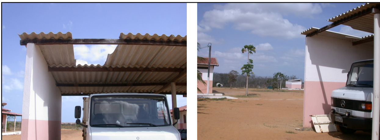
Figura 4.5. Estacionamento da sede administrativa da Camarus Aquacultura do Nordeste destelhada por ventos fortes no dia 9 de dezembro de 2005 entre as 10 e 12 h.
