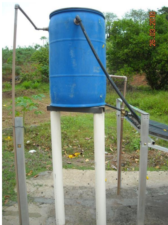
Figura 3.11. Tambor de PE para armazenamento de água quente.
