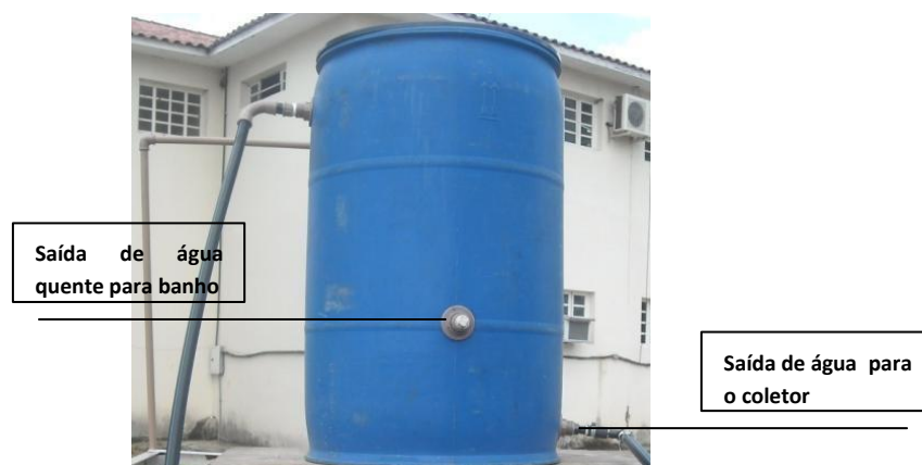
Figura 3.13. Detalhe dos furos no reservatório, vistos frontalmente.
