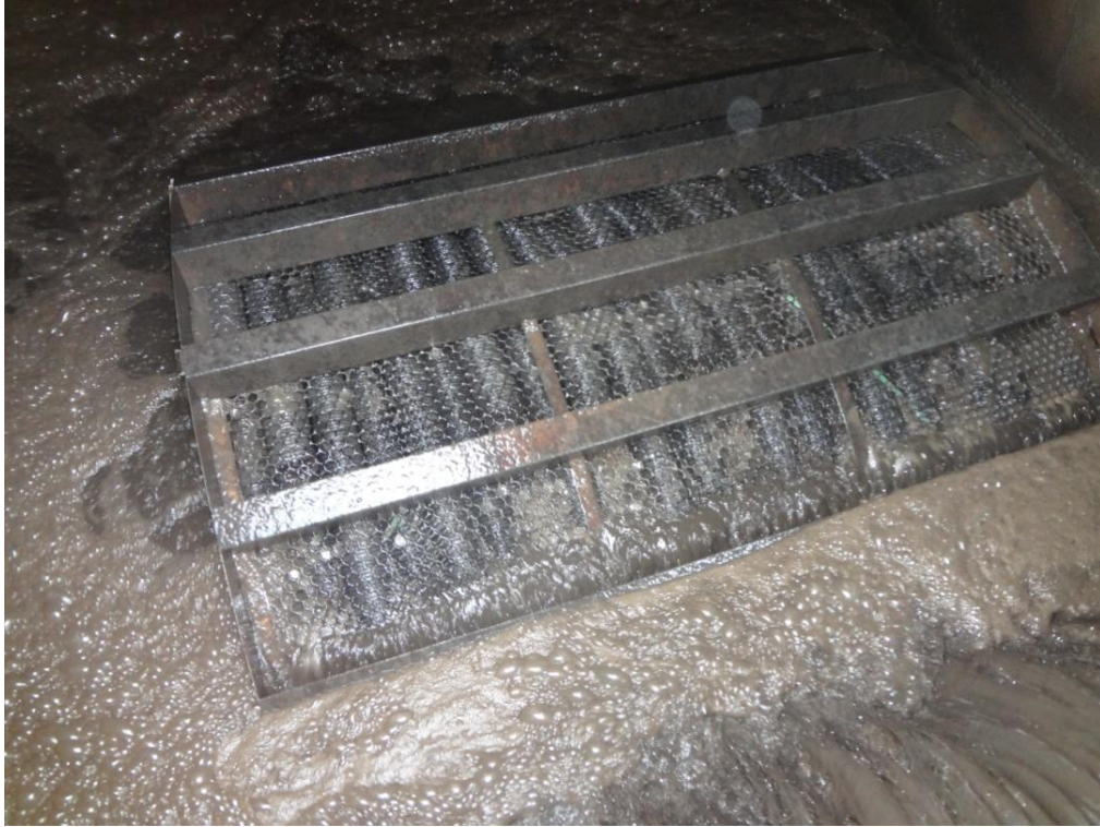
Figura 14: Tanque de aeração com Biodisco
