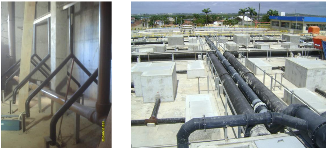
Figura 13: Parte interna e vista superior dos reatores UASB
