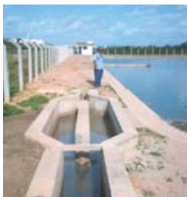
Figura 4.14 – Vista do tratamento preliminar da ETE Jardim Lola II (FONTE: André Calado).
