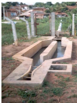
Figura 4.9 – Vista do tratamento preliminar da ETE Jardim Lola I.
