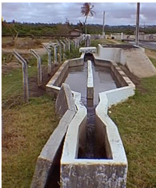
Figura 4.4 – Vista do tratamento preliminar da ETE Beira Rio.
