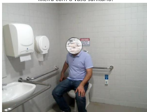
Figura 36. PSR-M-26 – Proximidade inadequada da lixeira com o vaso sanitário.
