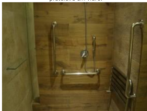
Figura 74. Ausência de indicações no comando e prateleira em vidro.
