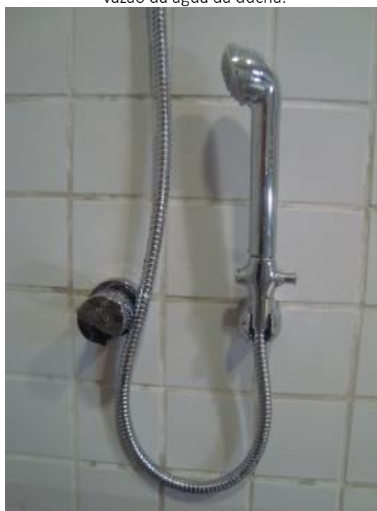
Figura 34. Ausência de mecanismo para regulagem da vazão da água da ducha.
