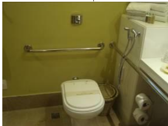
Figura 72. Ausência de possibilidade de regulagem de altura dos dispositivos.
