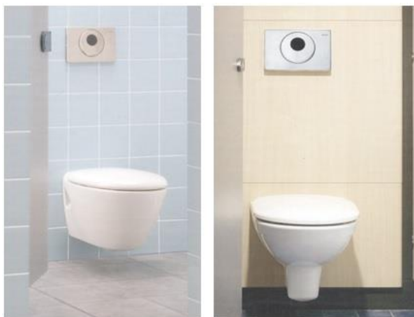
Figura 9. Bacia sanitária com descarga acionada por mecanismo de sensor.
