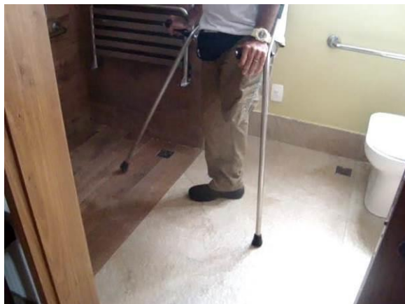
Figura 101. PMU-M-45 – Ausência de desnível entre a área de banho e o restante do banheiro.
