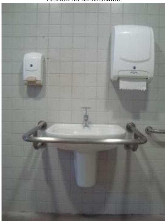
Figura 33. Posição inadequada do sabonete, que não fica acima da bancada.
