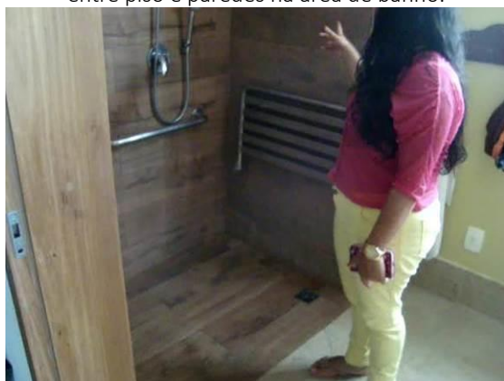
Figura 97. PBV-F-32 – Ausência de contraste de cor entre piso e paredes na área de banho.
