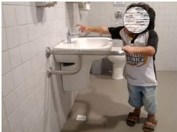
Figura 55. PBE-M-20 – Dificuldade para utilização do lavatório.
