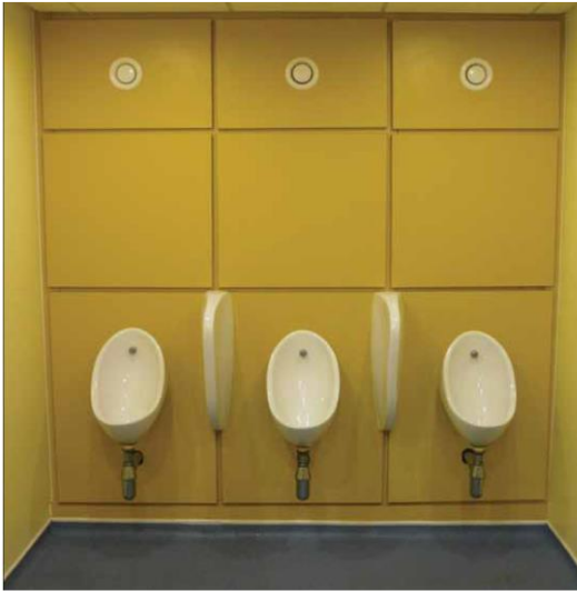
Figura 17. Contraste de cor entre paredes, piso e peças sanitárias.
