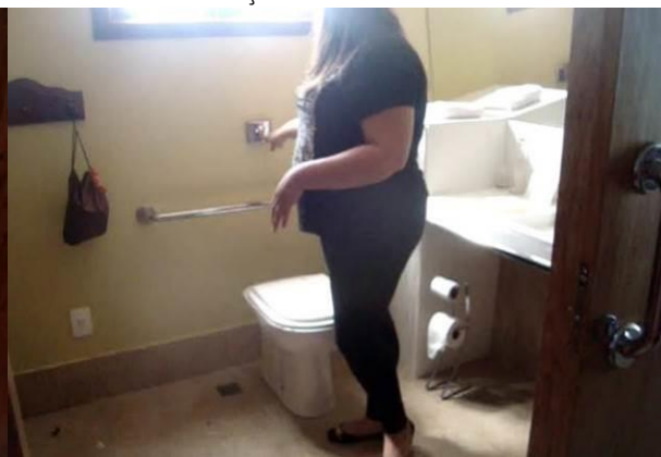
Figura 91. PO-F-28 – Acionamento da descarga exige força considerável.
