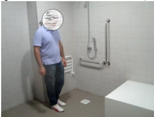
Figura 37. PSR-M-26 – Ausência de divisória no piso.
