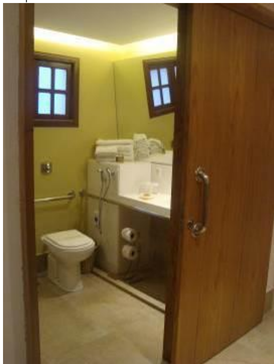
Figura 71. Ausência de contraste de cor entre piso e paredes e mecanismo de trava com chave.
