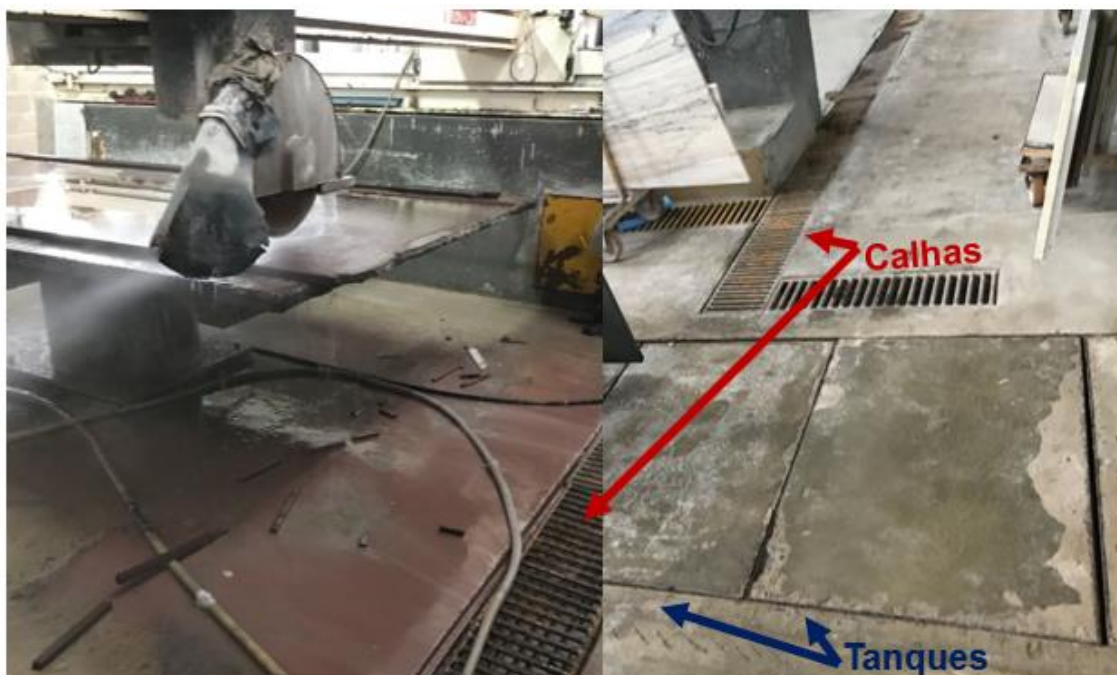
Figura 3.7 - Imagens da marmoraria e seu sistema de drenagem e armazenamento da lama de RGM, com os detalhes das calhas (dutos) e os tanques de decantação e sedimentação.
