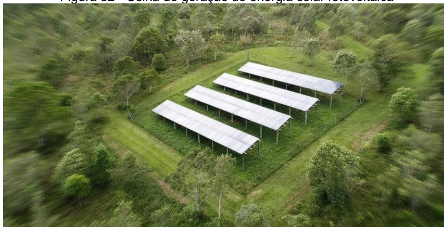
Figura 32 - Usina de geração de energia solar fotovoltaica
