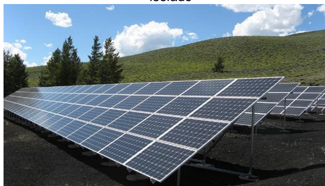
Figura 119 - Exemplo de módulos instalados em terreno isolado
