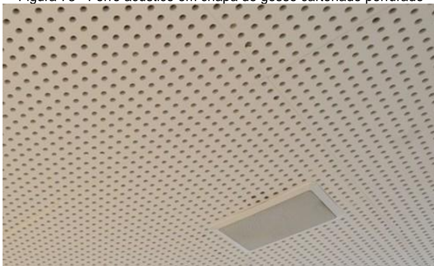
Figura 73 - Forro acústico em chapa de gesso cartonado perfurado
