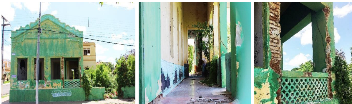
Figura 35 – Patologias no casarão verde Fonte: Autoria do Autor (2022)
