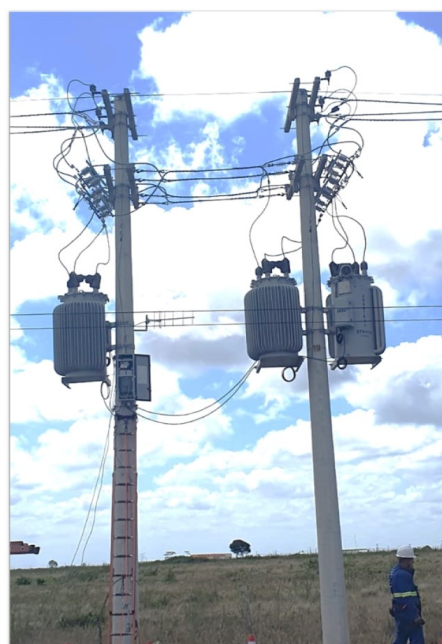
(b) Instalação Finalizada
