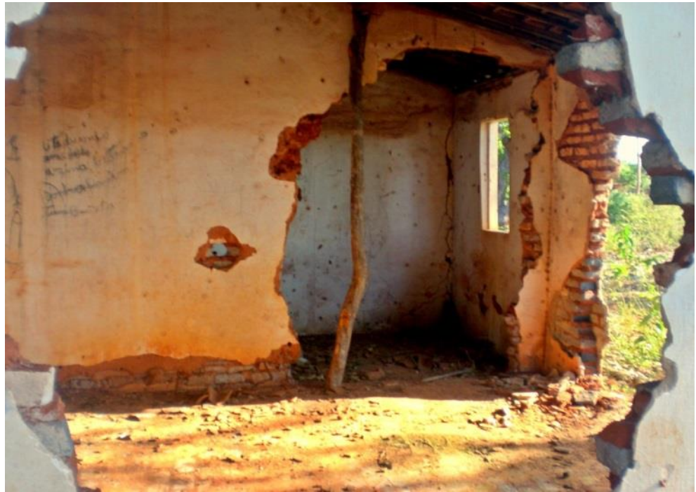
Figura 7: armazém de sementes – construção abandonada.
