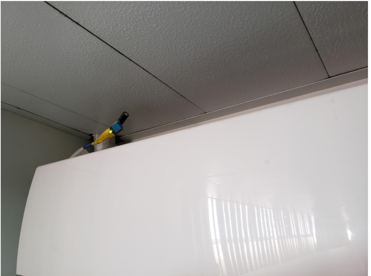
Figura 15: Foto do Sensor DHT na entrada de ar de um dos ar condicionados.
