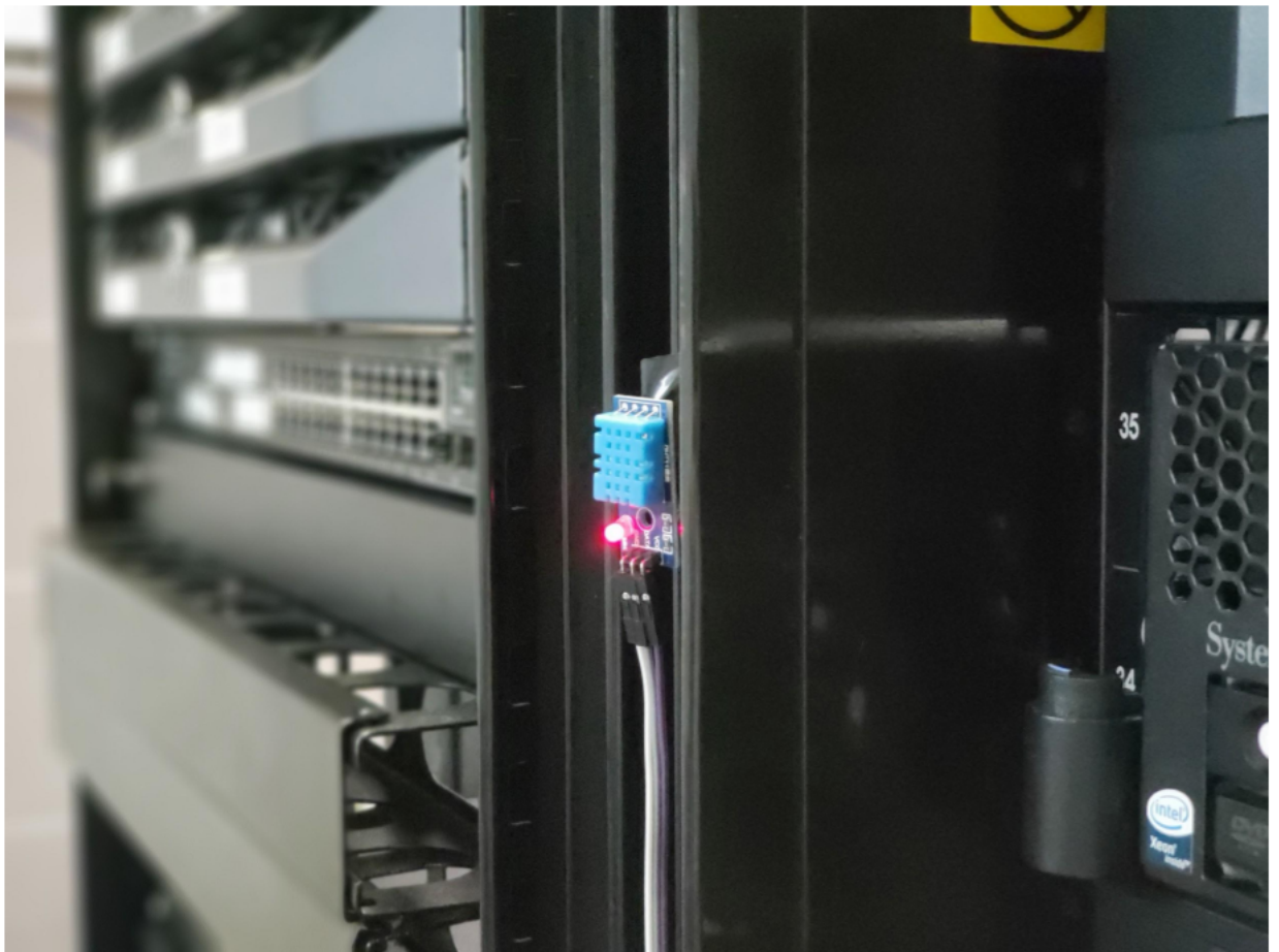
Figura 18: Foto do sensor do Módulo 04 na frente dos racks - Corredor Frio.
