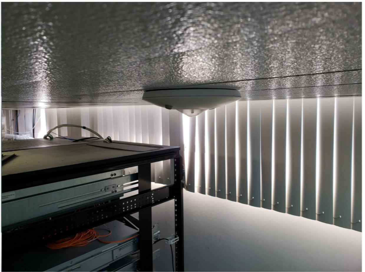
Figura 13: Foto do Módulo principal pendurado no teto do Data Center.
