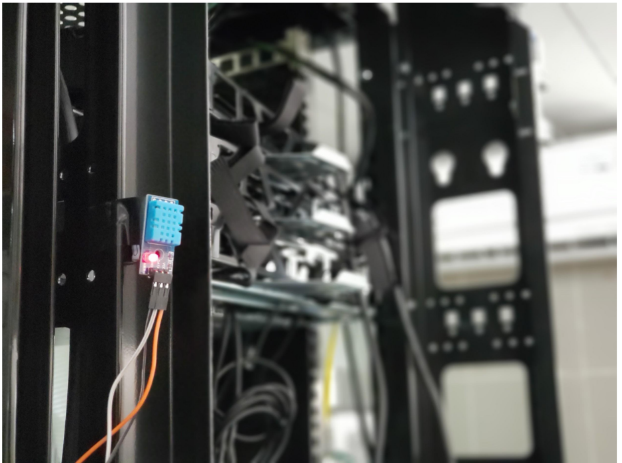
Figura 17: Foto do sensor do Módulo 04 na traseira dos racks - Corredor Quente.
