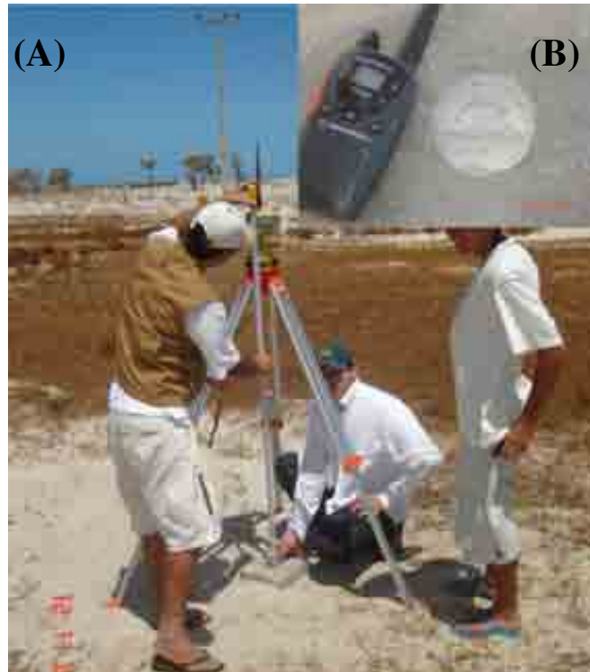
Figura 1.20 – (A) Base principal sendo instalada na área. (B) Destaque da chapinha de reconhecimento.
