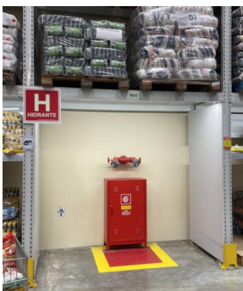
Figura 32 Exemplo de espaço criado para a acomodação do sistema de hidrante
