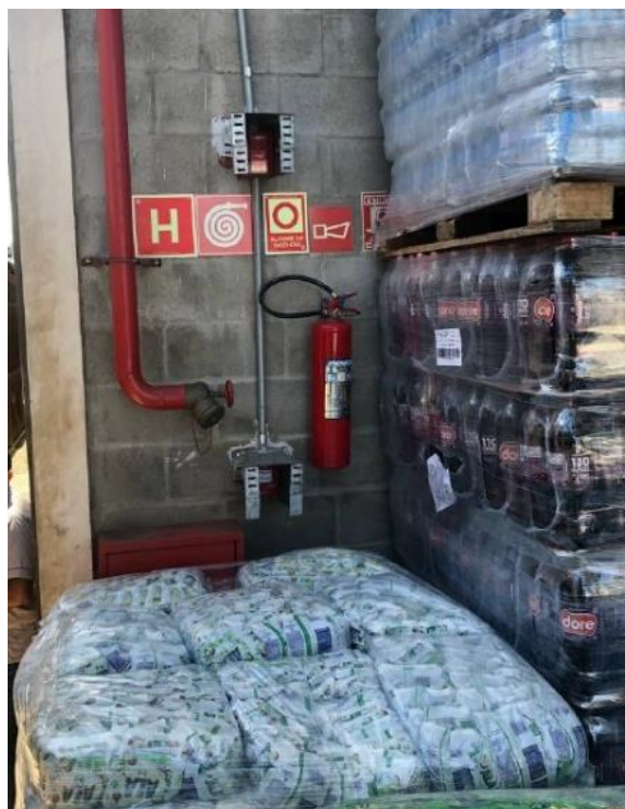
Figura 30 Exemplo de obstrução de equipamento de SCI na área de docas
