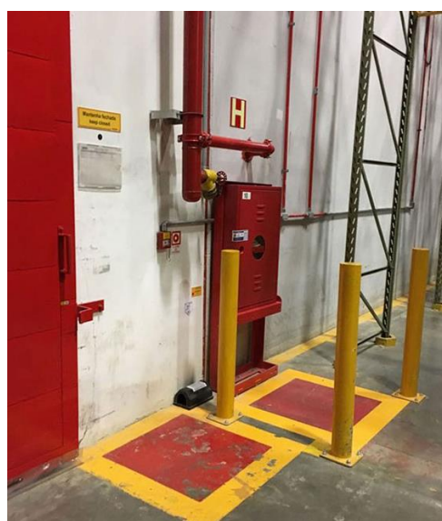
Figura 33 Exemplo de anteparos criados para evitar a obstrução do sistema de hidrantes
