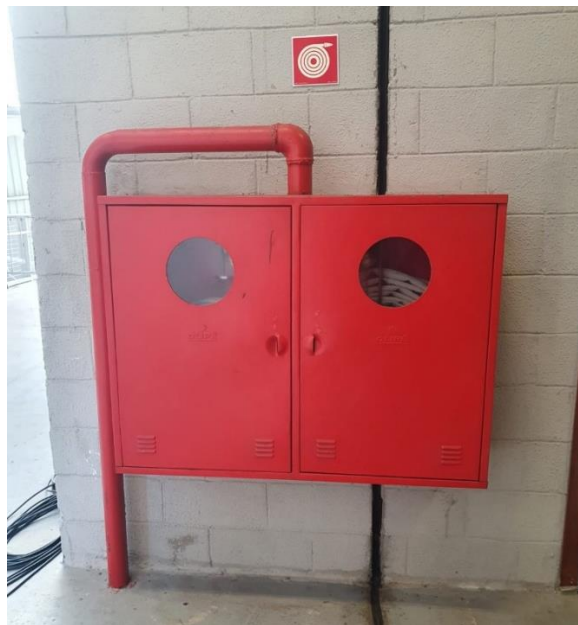
Figura 17 Hidrante duplo com abrigo para quatro mangueiras
