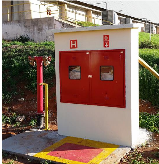
Figura 18 Hidrante duplo externo com abrigo para quatro mangueiras
