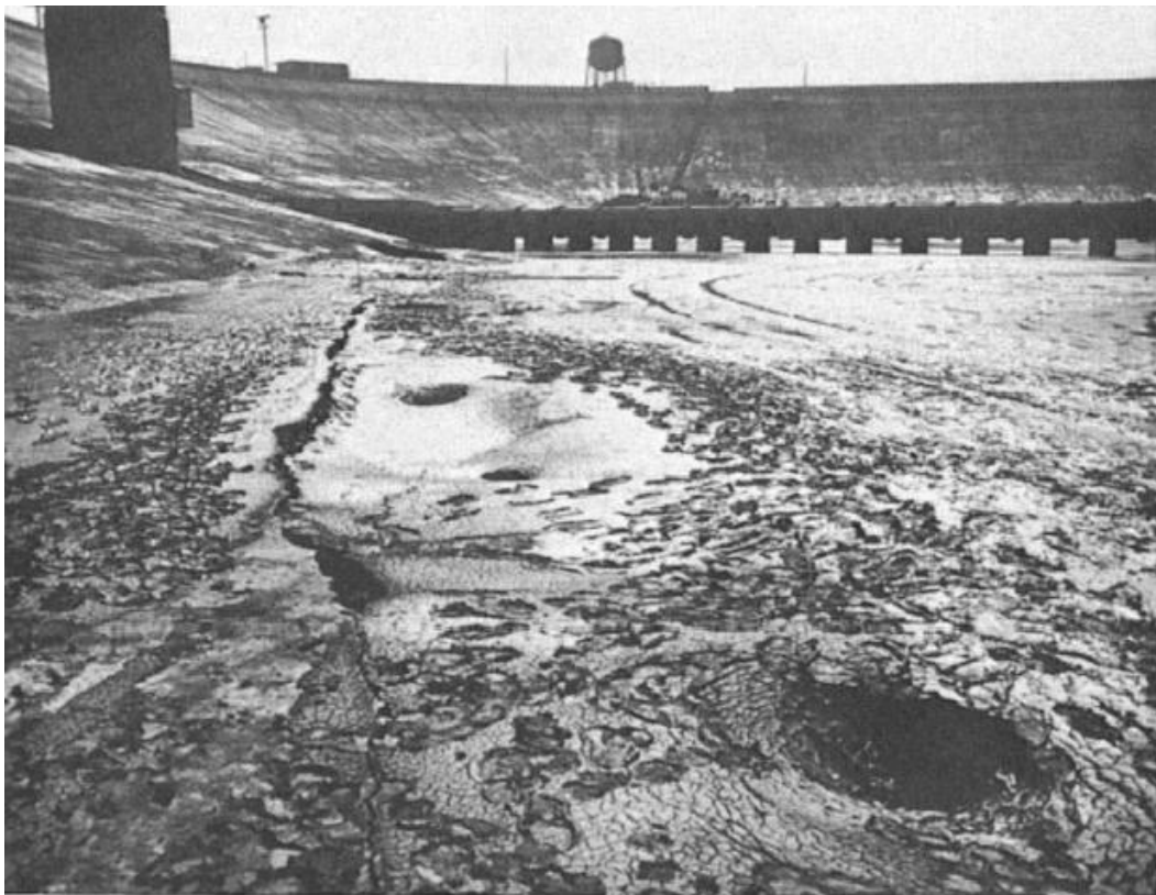
Figura 2.25 – Fotografia de dentro do reservatório após a ruptura (Jansen, 1987)
