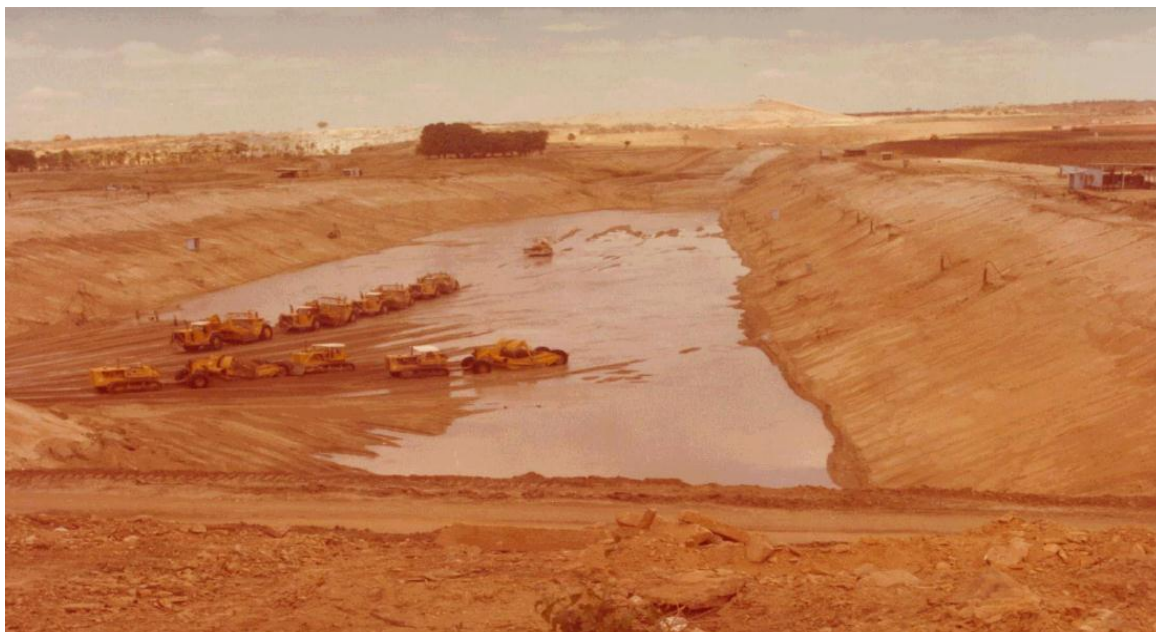
Figura 3.6 – Nível d'água aflorante na escavação do cut-off (Rocha, 2003)
