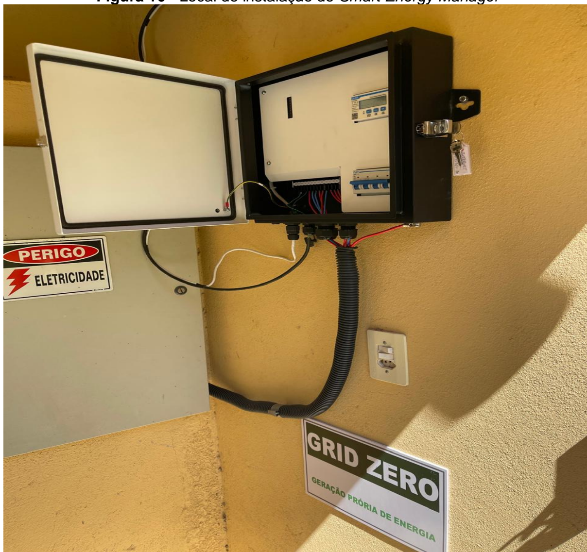
Figura 16 - Local de instalação do Smart Energy Manager
