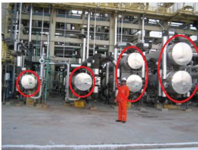
Figura 2 – Trocadores de calor (permutadores) na RPCC
