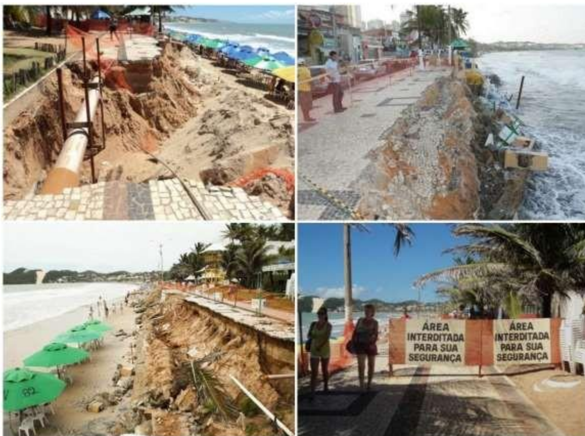
Figura 06 – Trechos desmoronados do calçadão de Ponta Negra em Natal/RN.
