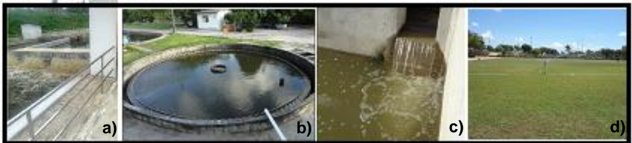
Figura 2 - Etapas de tratamento do efluente da ETE: Valo de oxidação (a), tanque de decantação (b), água de reuso (c) e aplicação da água de reuso no campo de futebol (d).
