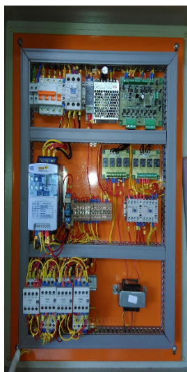
(a) Primeiro protótipo instalado em quadro de comando de bombas
