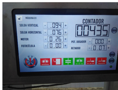
(c) Detalhe da IHM personalizada de máquina de envase (com comunicação bluetooth para envio de comandos ao CLP)
