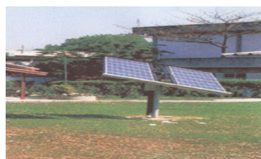
Figura 2.24. Sistema Fotovoltaico Móvel
