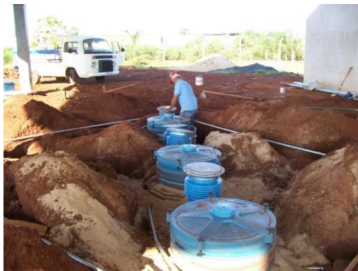
Figura 2.12. Tubulação de monitoramento e medição.
