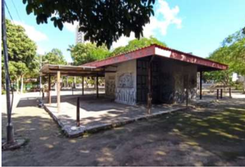
Figura 101: Quiosque que teve esquadrias fechadas com tijolos
