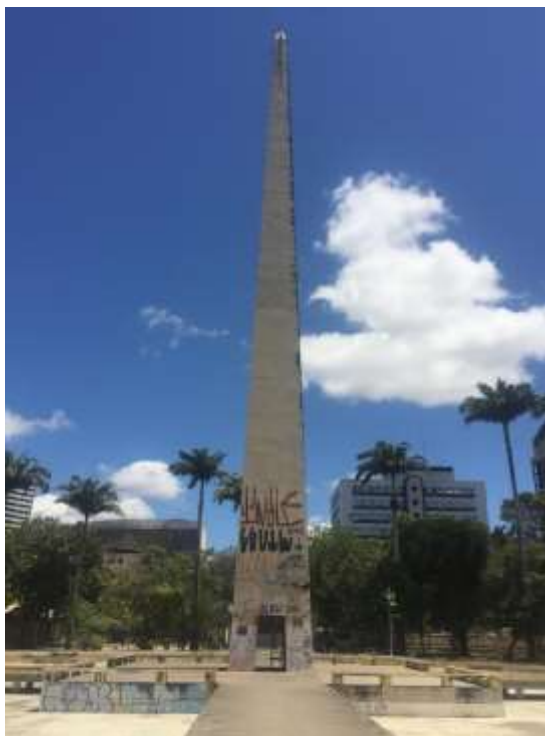
Figura 63: Estado de conservação do obelisco e fonte luminosa
