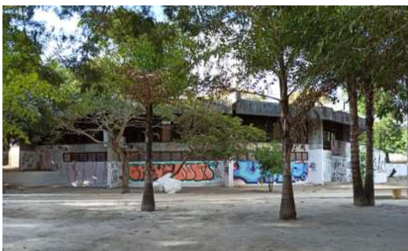
Figura 49: Muro que encobriu os pilotis que sustentavam o museu
