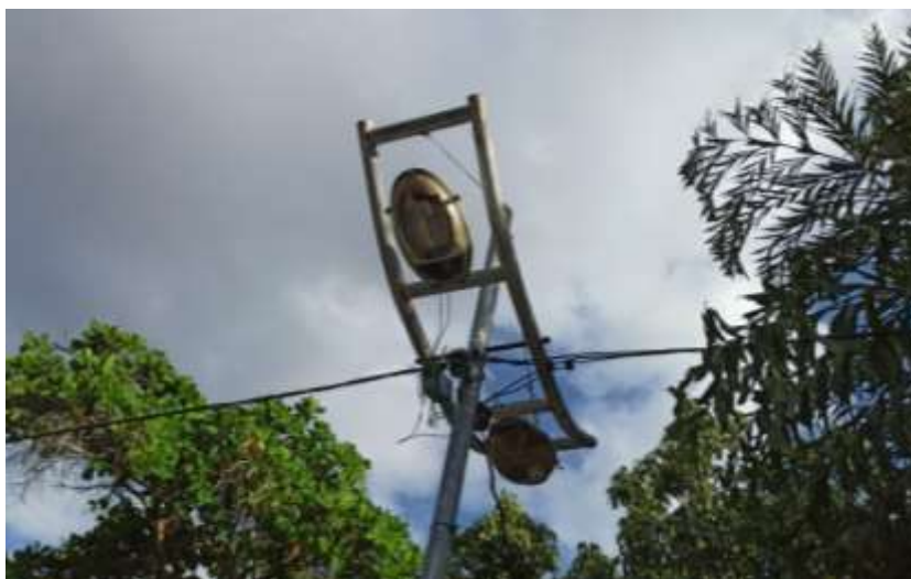
Figura 67: Lâmpada quebrada no PEC
