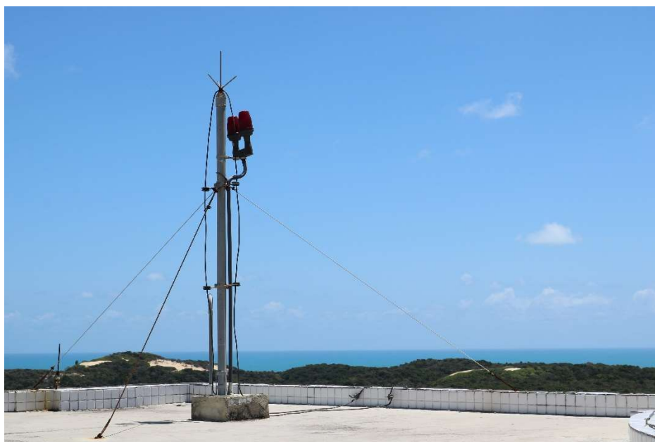
Figura 3.65 - Para-raio com luz de balizamento no topo do edifício.
