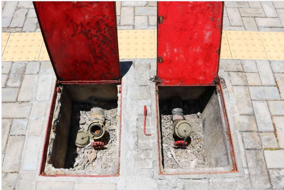
Figura 3.25 - Dispositivos de recalque para hidrante e sprinkler.
