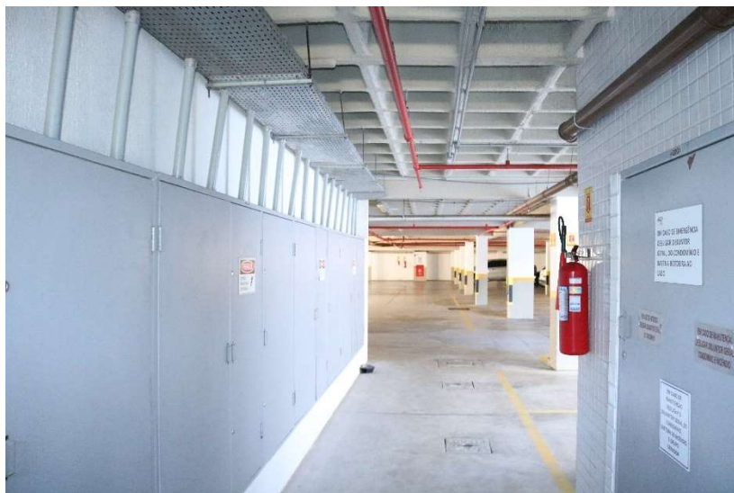
Figura 3.63 - Sinalizações de emergência complementares escritas em quadros de energia elétrica.
