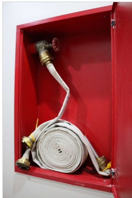
Figura 3.27 - Abrigo do hidrante com mangueira aduchada acoplada ao registro angular
