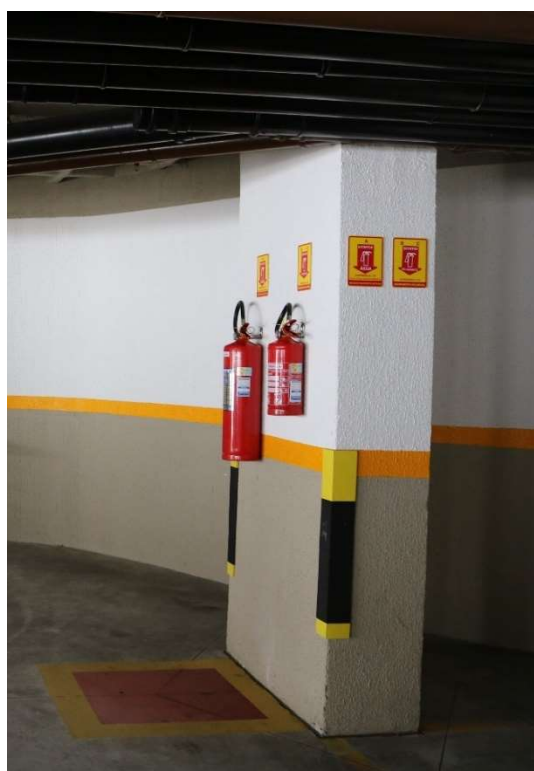
Figura 3.60 - Sinalização de emergência em todos os lados do pilar, de obstáculos e de piso para extintores.
