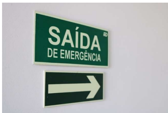
Figura 3.61 - Sinalização de saída de emergência e sinalização complementar
