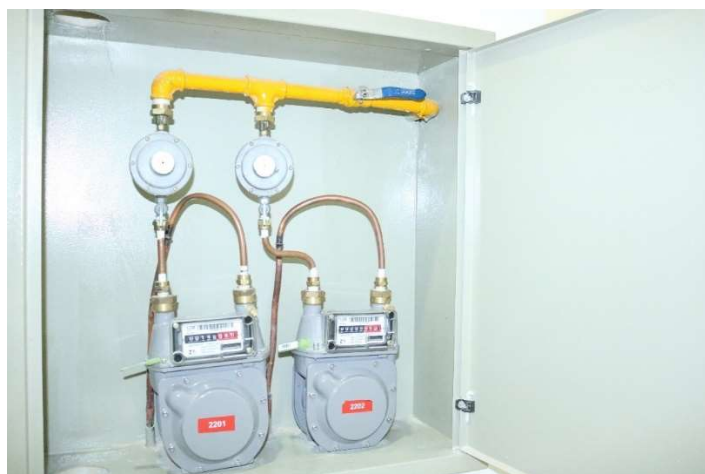
Figura 3.38 - Caixa de medidores de gás em pavimento tipo de edifício.
