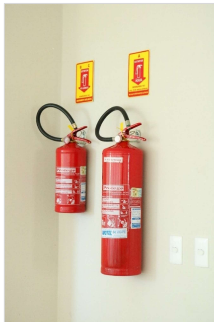
Figura 3.15 - Extintores de incêndio instalados na parede (Pó químico BC 4kg e Água pressurizada 10L)
