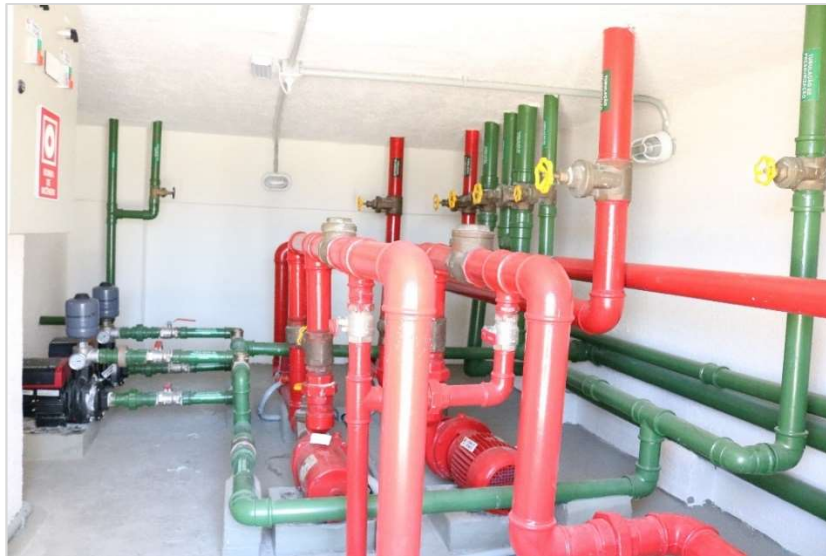
Figura 3.18 - Barrilete onde se encontram as bombas de incêndio.
