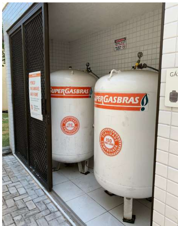
Figura 3.36 - Casa de gás para dois cilindros de GLP P-500
