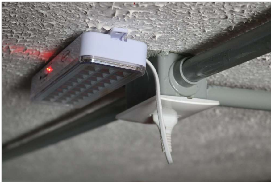
Figura 3.56 - Iluminação de emergência em bloco autônomo no teto.
