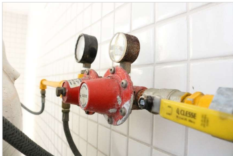
Figura 3.40 - Instalação dos cilindros demonstrando os manômetros, regulador de 1º estágio, registro de esfera e o pig tail.
