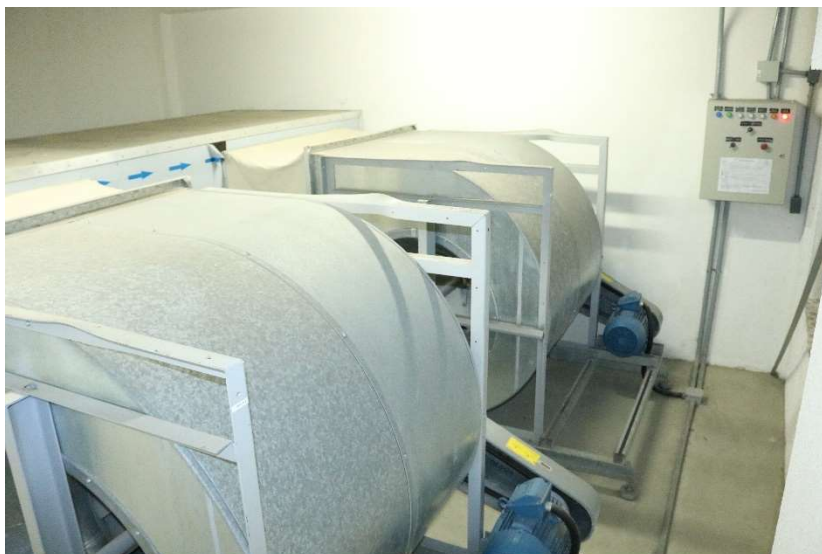
Figura 3.51 - Pressurizadores de ar para a escada.
