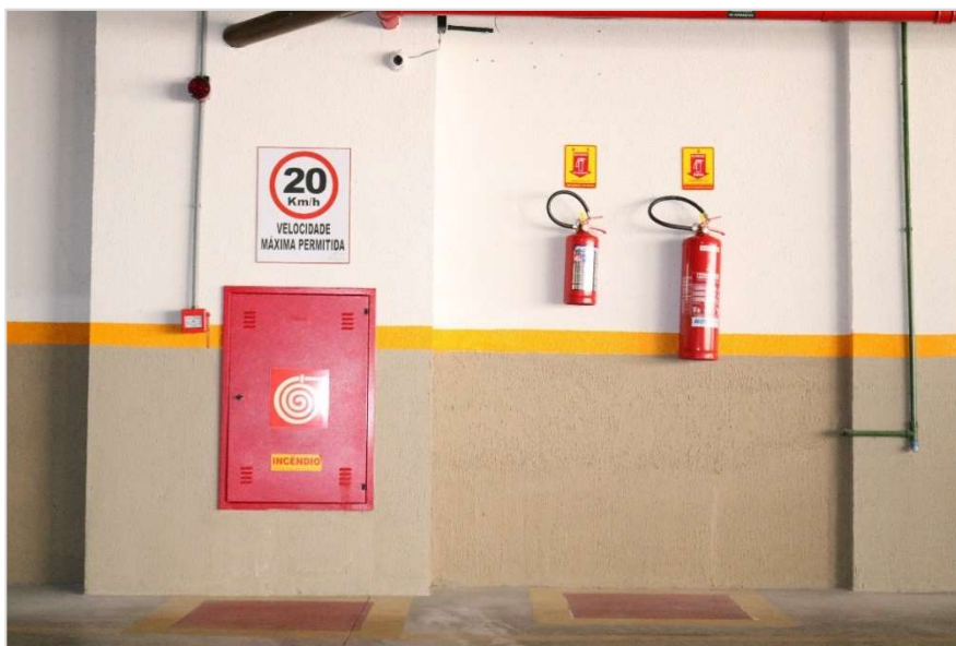
Figura 3.23 - Abrigo dos hidrantes próximo ao acionador manual e sirene, junto a um par de extintores.
