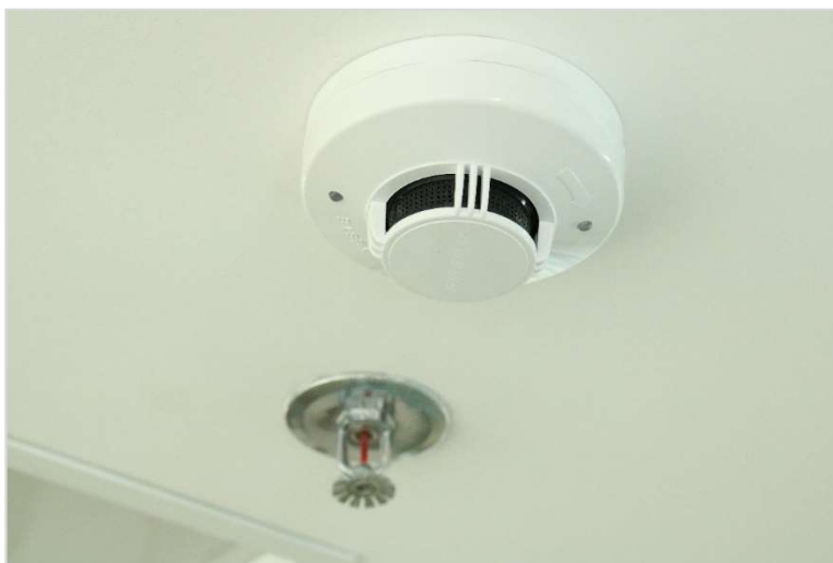
Figura 3.32 - Sprinkler ao lado de um detector de fumaça no forro.
