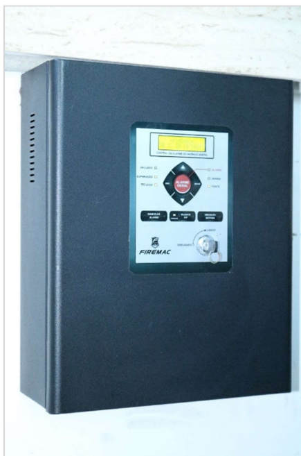
Figura 3.64 - Central de alarme de incêndio.
