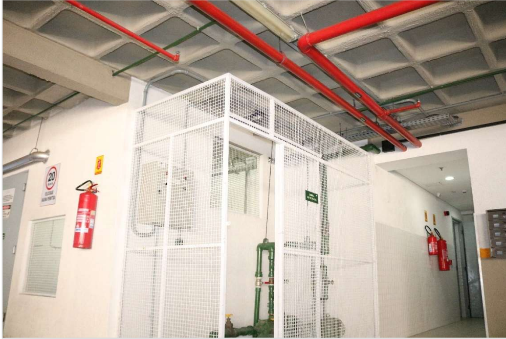
Figura 3.13 - Extintor exclusivo para proteção da casa de bombas, independente dos demais.
