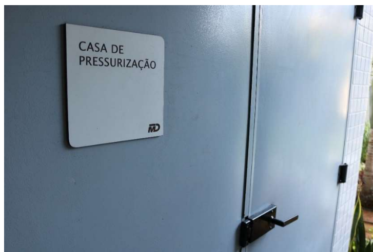
Figura 3.50 - Porta corta-fogo de duas folhas para entrada na casa de pressurização
