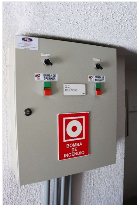
Figura 3.21 - Quadro de comando manual das bombas de incêndio.
