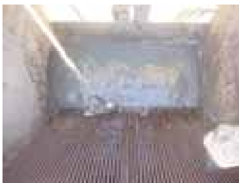
Figura 5.3 – Tratamento preliminar da ETE
