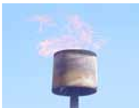
Figura 5.8 – Queimador de biogás da ETE
