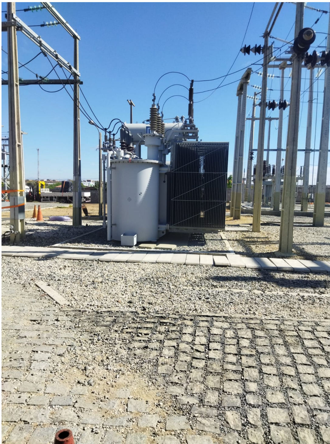
Figura 47 – Transformador 69 kV - 13,8 kV da subestação.
