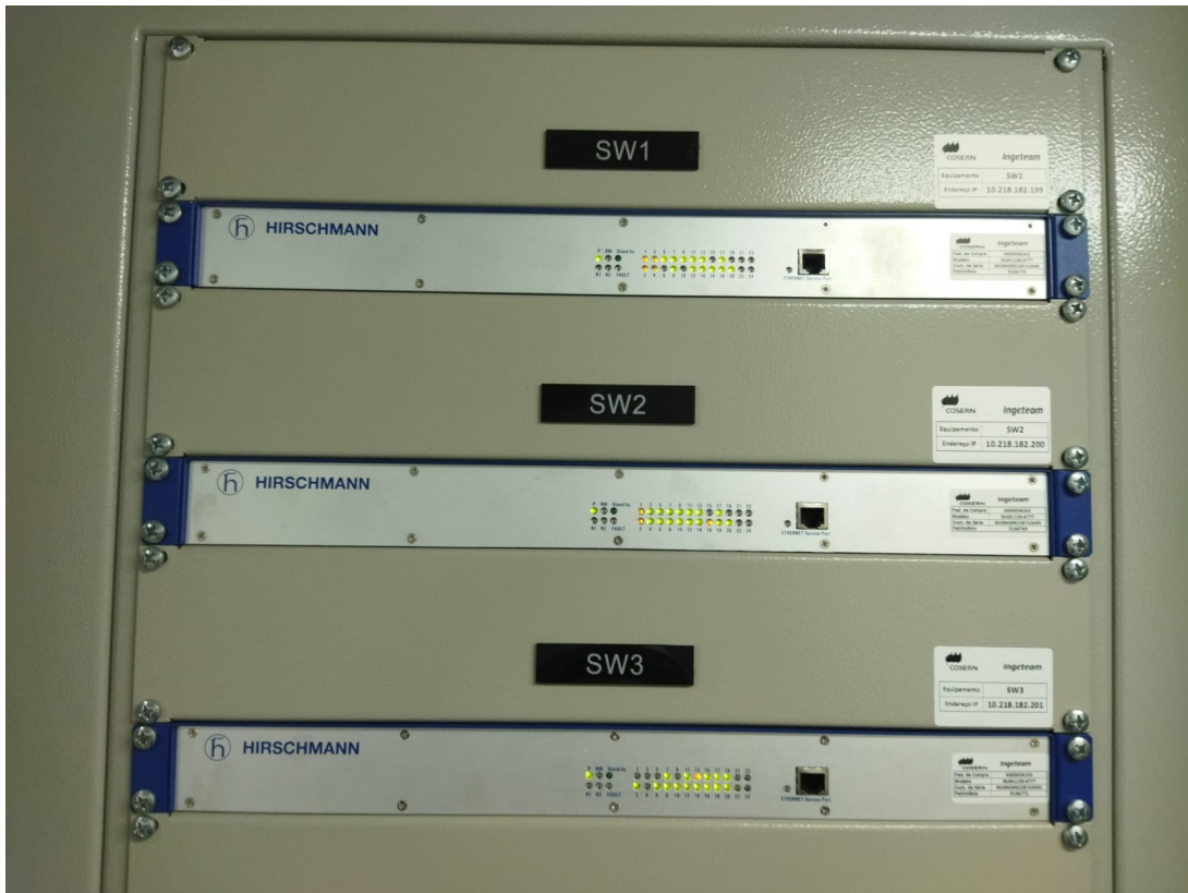
Figura 52 – Switches para configuração de equipamentos na rede.
