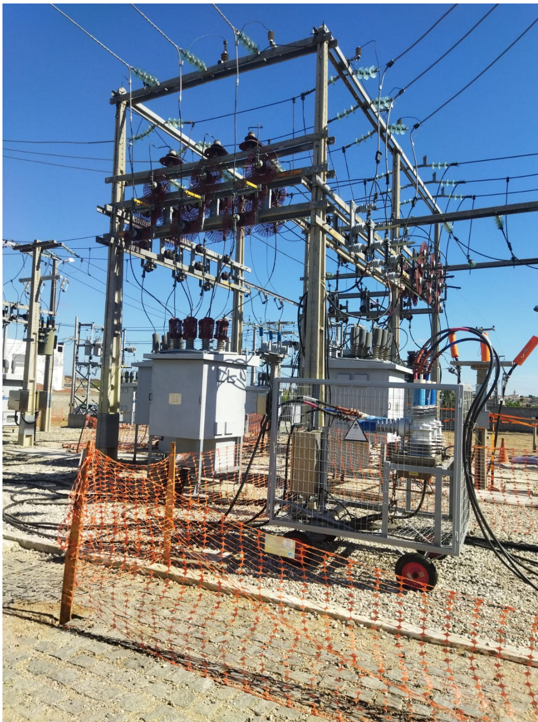
Figura 46 – Alimentadores da subestação em campo.
