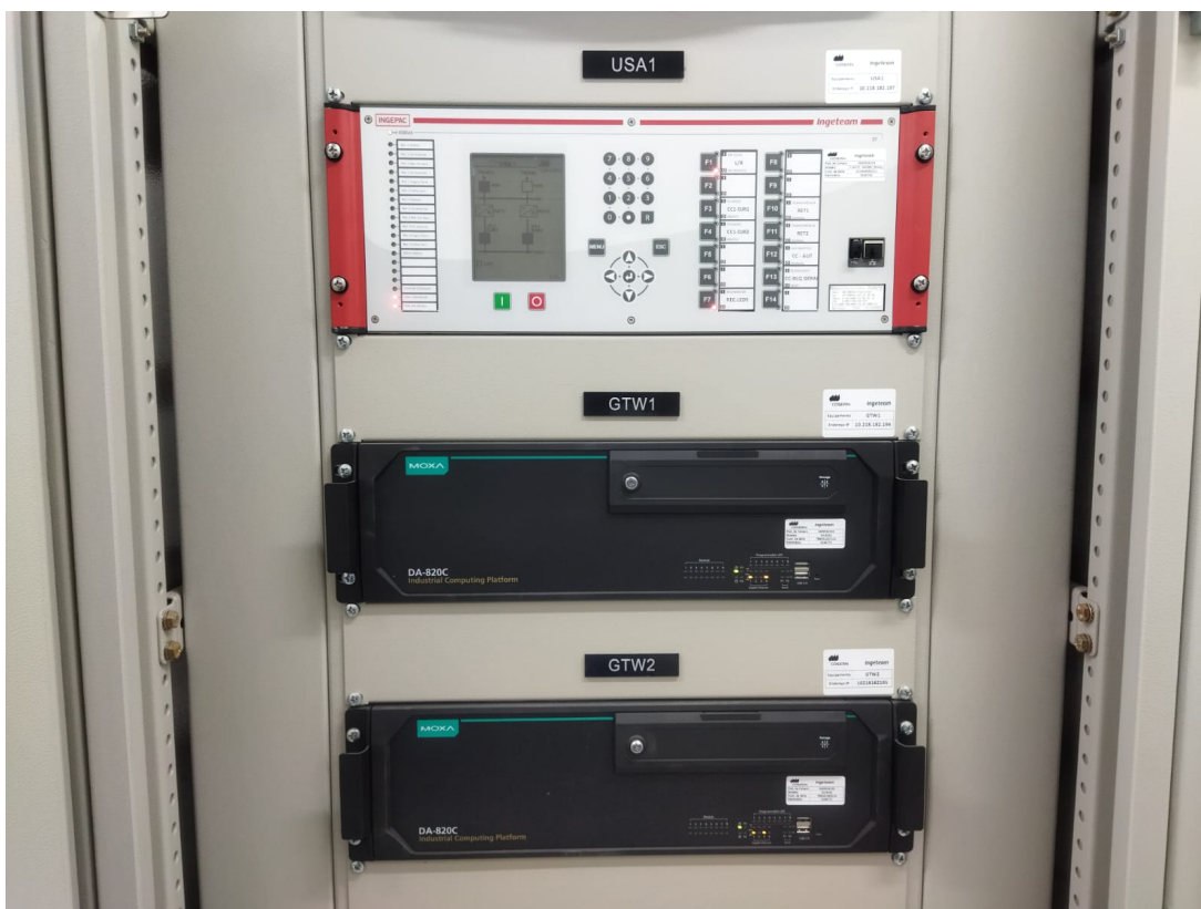
Figura 48 – Relé da USA (serviços auxiliares) e gateways.
