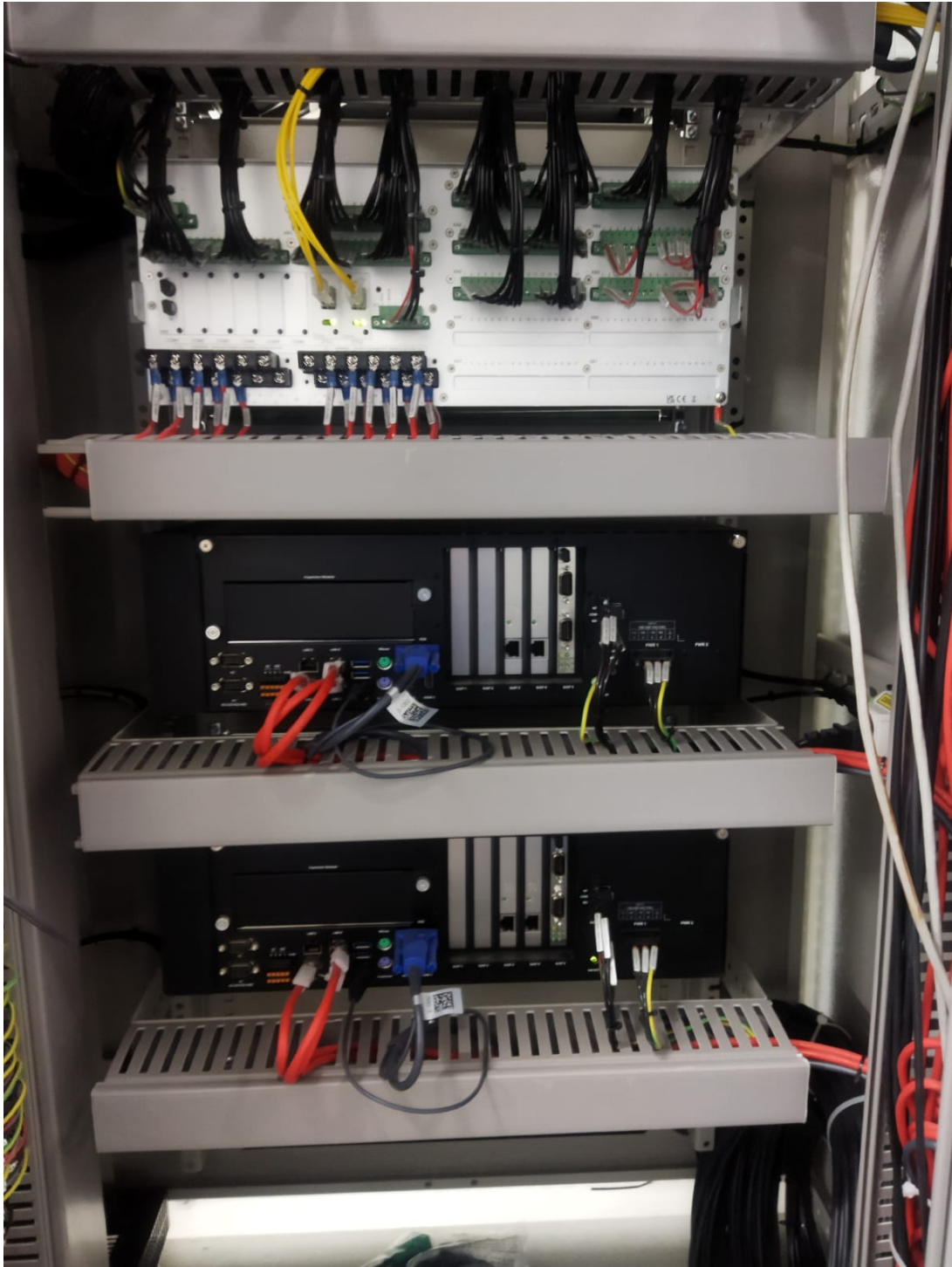
Figura 53 – Ligação traseira dos servidores em redundância.
