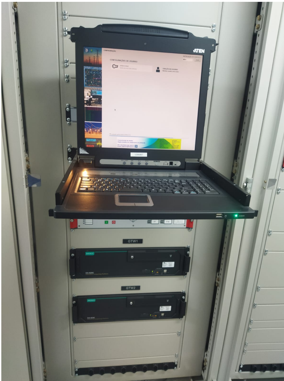
Figura 4 – Switch KVM e Servidores MOXA DA-820C Series, nos quais rodam os sistemas SAGE em redundância.
