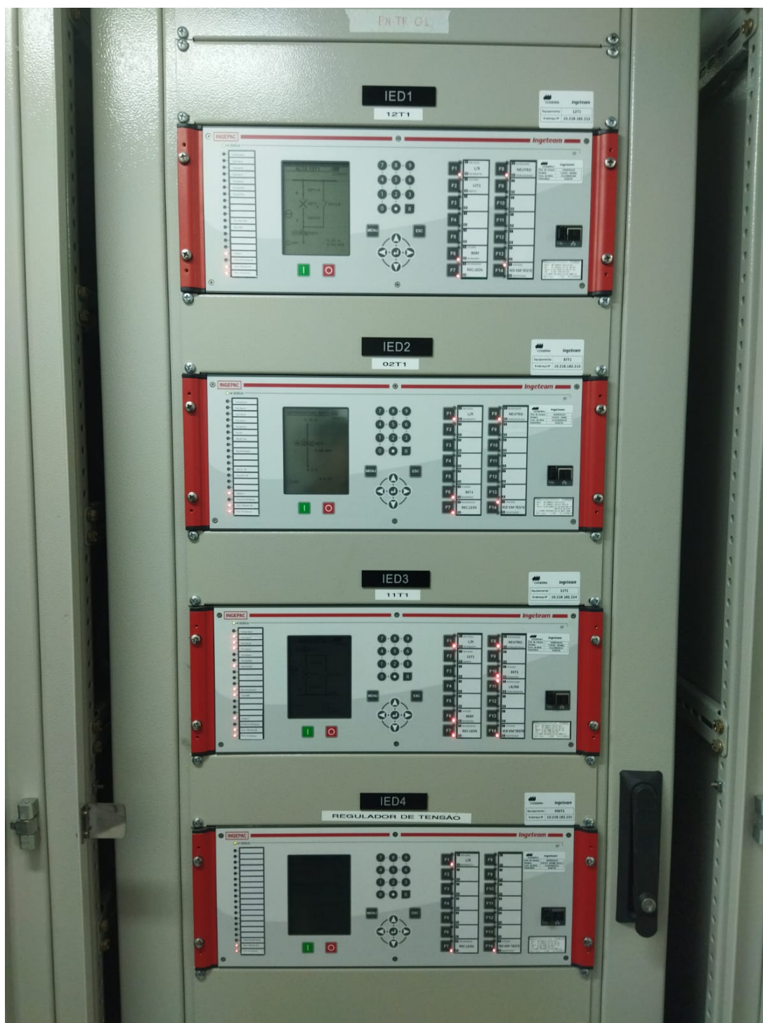
Figura 51 – IEDs das linhas de transmissão (alta) da subestação.
