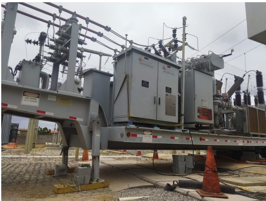
Figura 45 – Subestação móvel pertencente à concessionária.
