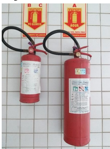
Figura 14 – Par de extintores.
