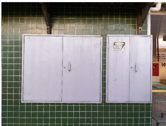
Figura 17 – Quadro elétrico geral.
