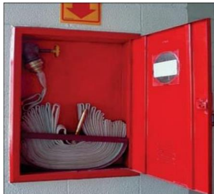
Figura 06 - Sistema de hidrantes.
