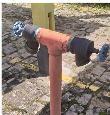
Figura 12 – Hidrante sem abrigo.
