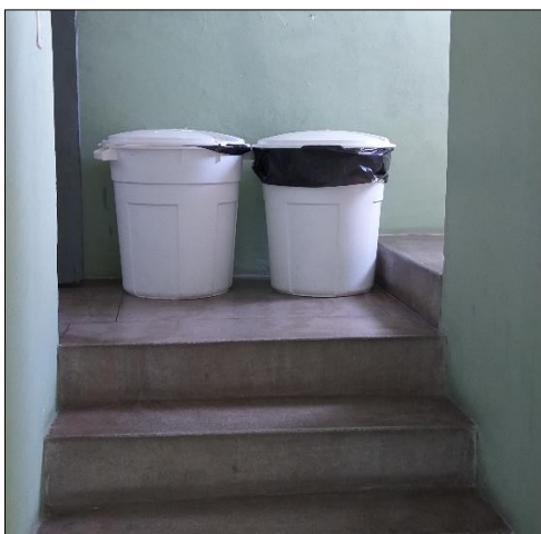
Figura 19 – Lixeiras no patamar da escada e ausência de corrimão.
