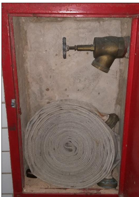
Figura 15 – Hidrante sem a junta storz.
