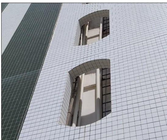
Figura 22 – Tubulação passando pela face externa do prédio.
