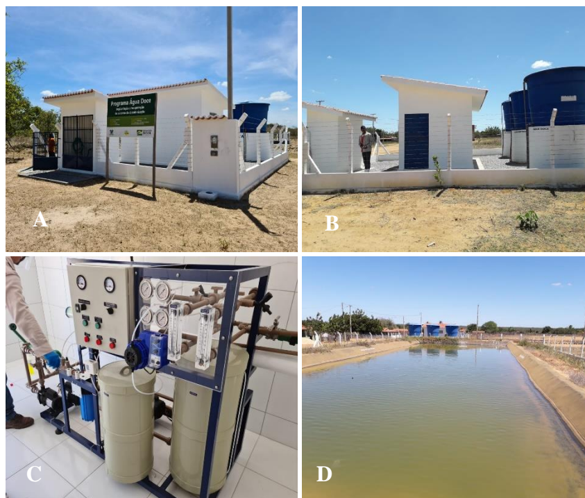
Figura. 2. Sistemas de dessalinização implantados em comunidades rurais do semiárido do Rio Grande do Norte: abrigo do dessalinizador e caixas da água (A, B); dessalinizador (C) e tanque de disposição do concentrado salobro (D).
