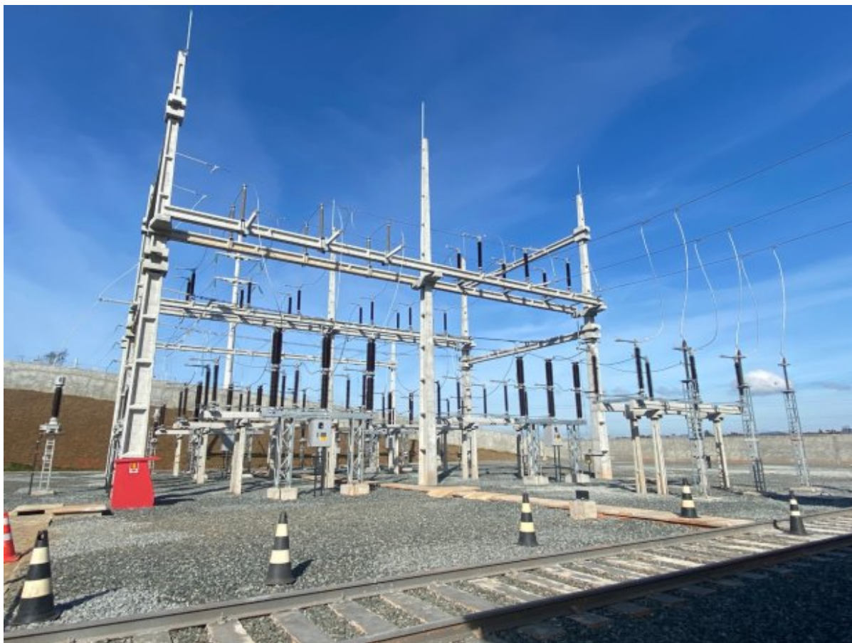
Figura 6 – Subestação de distribuição da Celesc Distribuição S.A.
