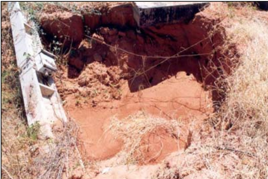
Figura 5.4 – Detalhe do colapso de terreno, mostrado na foto 5.3, que provocou a queda de um poste próximo ao pátio de tancagem da ETE/ETO.
