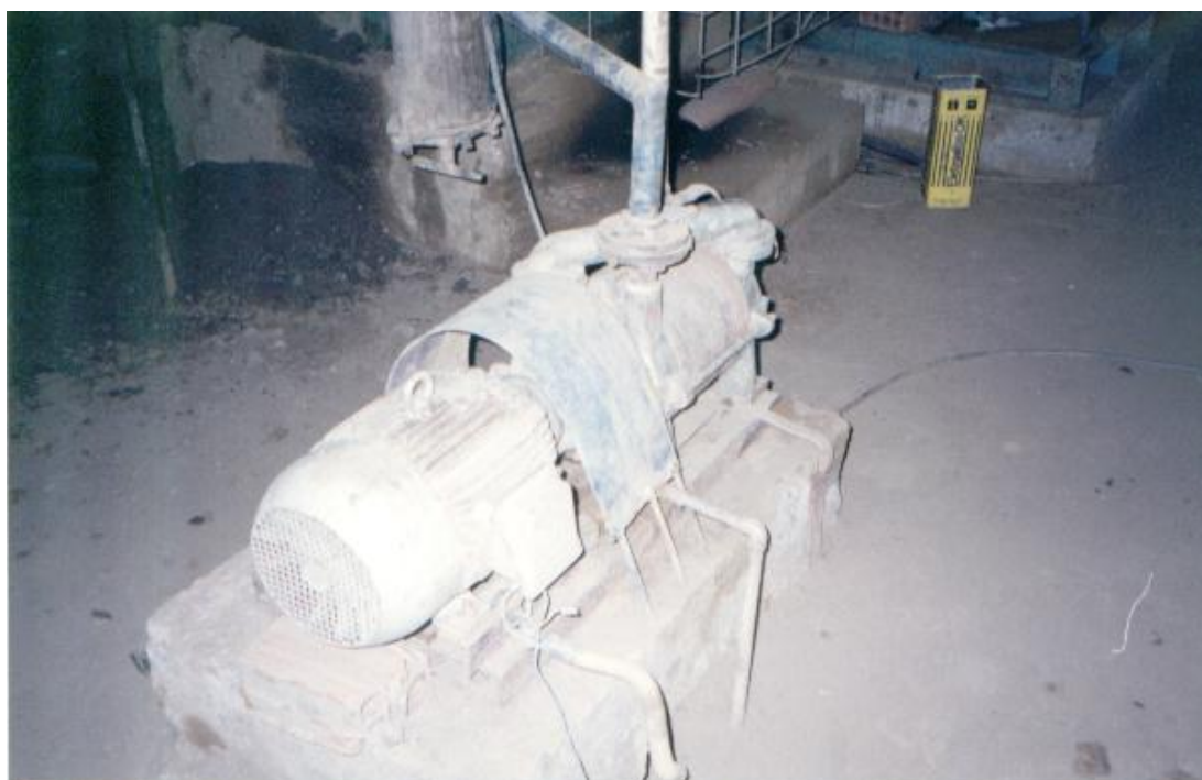
Figura 25: Bomba de vácuo acoplada à maromba extrusora
