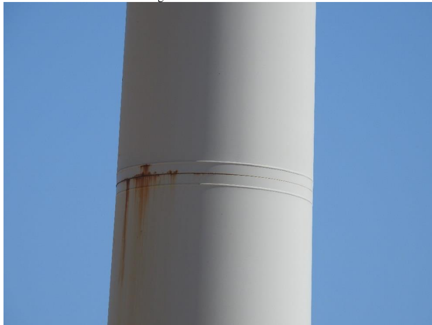
Figura 7 Torre metálica oxidada
