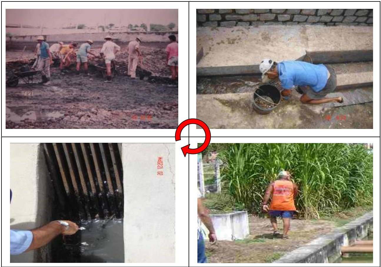
Figura 26 – Operadores de ETEs sem uso de EPIs e com vestimenta inadequada ao trabalho.
