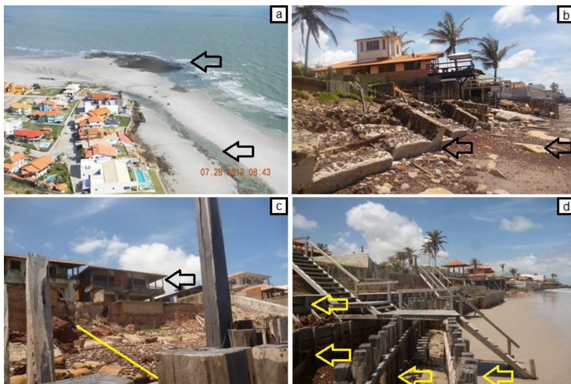
Figura 5.43: Indicativos de erosão costeira na praia do Atalaia, Salinópolis/PA: (a) Afloramento da formação Pirabas nos canais e na ponta da praia (setas pretas) (b) muro de arrimo (notar várias gerações de muros colapsados, setas pretas), (c) forte retração da falésia do Grupo Barreiras (linha amarela) (notar casas comprometidas, seta preta) e (d) várias medidas mistas de contenção por estaqueamento e pedras no estirâncio (setas amarelas). Fonte: LAIT e GEOPRO.
