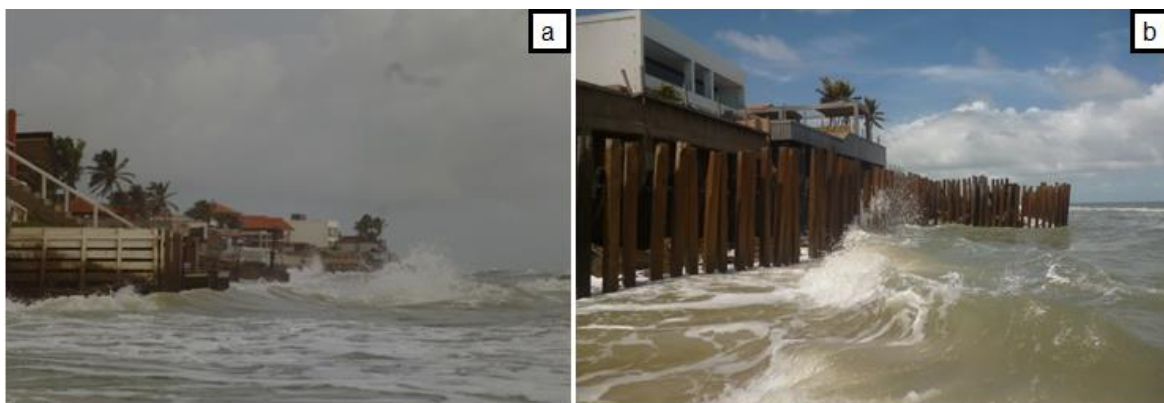
Figura 5.31: Maré alta incidindo sobre obras de contenção à erosão na praia do Atalaia, Salinópolis/PA durante (a) período chuvoso (abril de 2012) e (b) período seco (novembro 2014).
