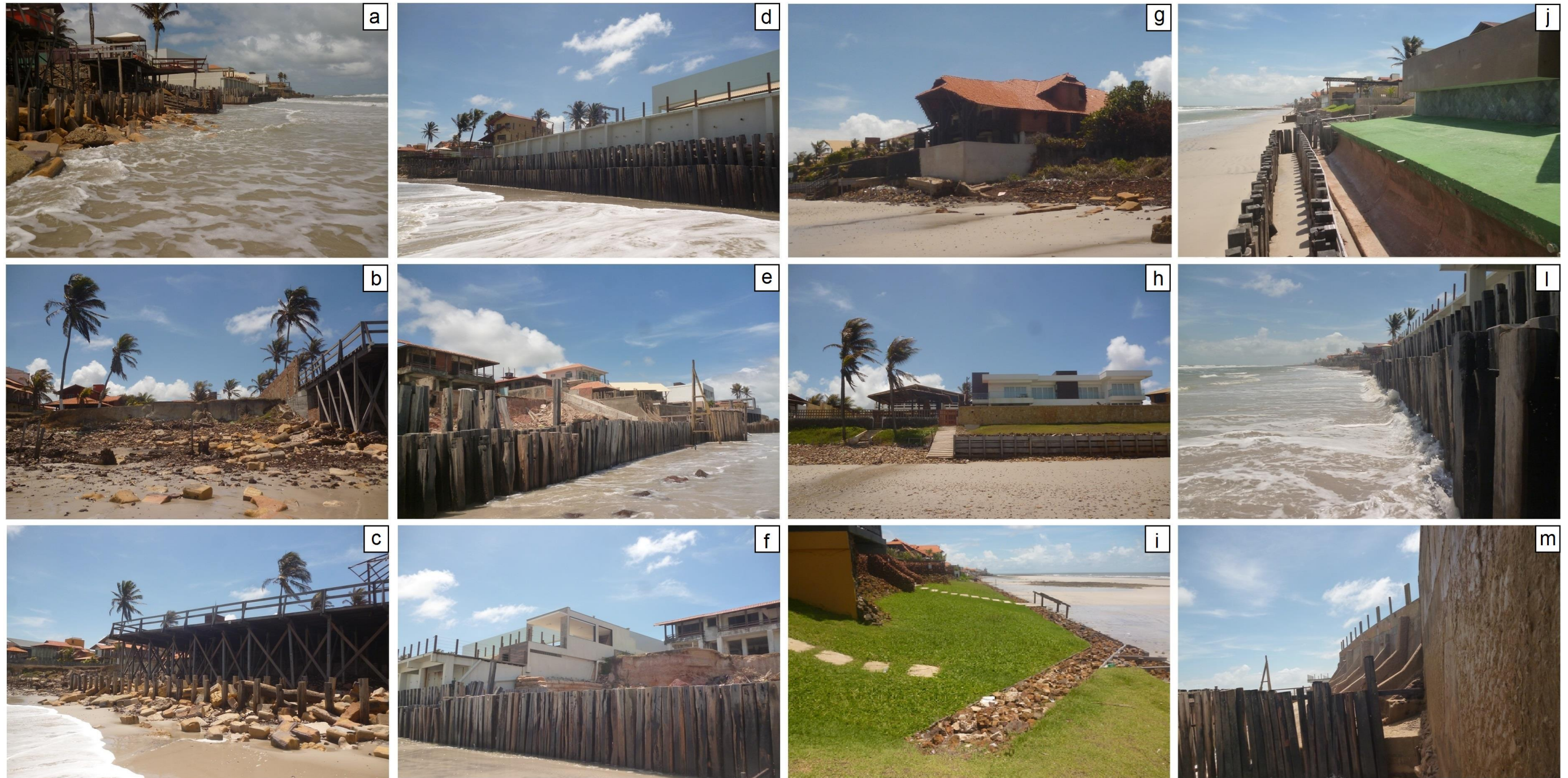
Figura 5.45: Tipos de obras de contenção na praia do Atalaia, Salinópolis/PA. (a, c) Estaqueamento + restos de muros de contenção, (b) Restos de muros, nenhuma reconstrução atual, (d, e, f, l) Estaqueamento duplo, (g) Muro de arrimo (à esquerda) e terreno sem proteção (à direita) (h) Vegetação natural (à esquerda) e caixa de madeira e pedra + aterro vegetado (à direita), (i) Caixa de madeira e pedra + aterro vegetado, (j) Estaqueamento duplo + rampa e (m) Estaqueamento + muro rampado. Fonte: LAIT e GEOPRO.
