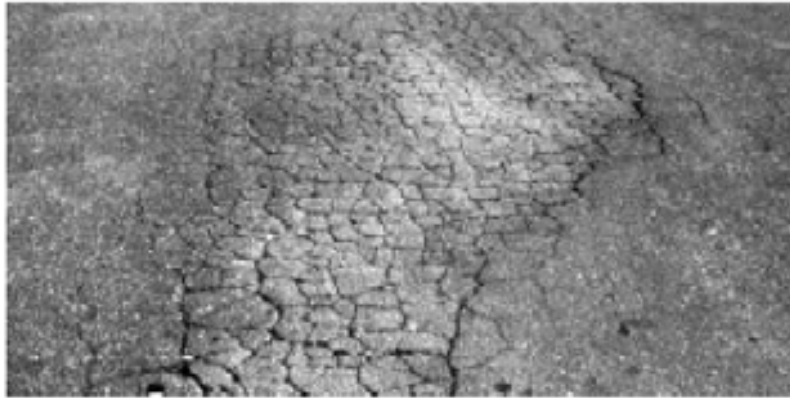
Figura 1.1. Trincas por fadiga do revestimento asfáltico.
